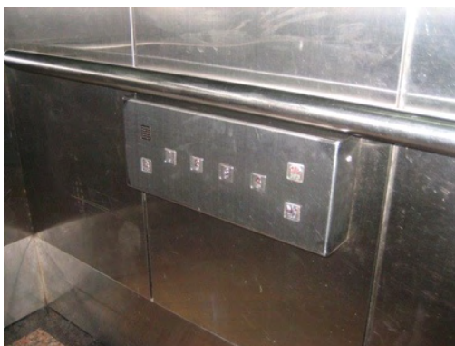
写真 2-5-5 KL セントラル駅エレベーター
