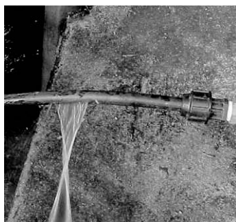
黒色ポリエチレン製 給水管からの漏水
