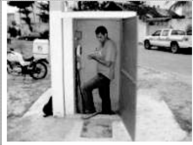
DMC 伝送設備の点検
