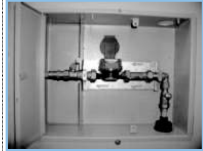
UMA(壁埋め込み式メーター) の内部
