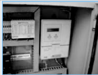
計装設備の内部
