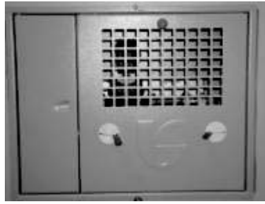
UMA(壁埋め込み式メーター) の表扉
