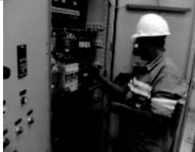
計装設備の点検
