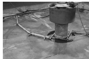
Nguồn: nhóm nghiên cứu JICA Hình 3.4.16 Gạt bùn ở bể lắng thứ cấp
