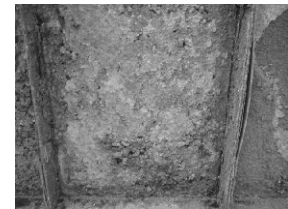
Nguồn: nhóm nghiên cứu JICA Hình 3.4.15 Nắp bể bị gỉ
