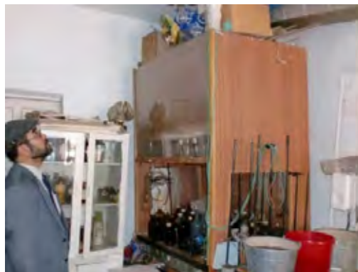
Фото 3-22 Лаборатория глицериновой химии. Вентиляционное устройство.
