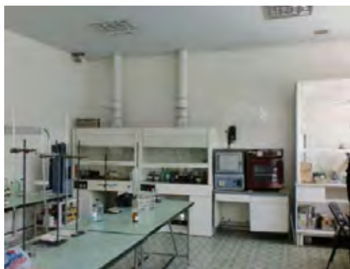
Фото 4-44 Лаборатория. Вентиляционное оборудование.
