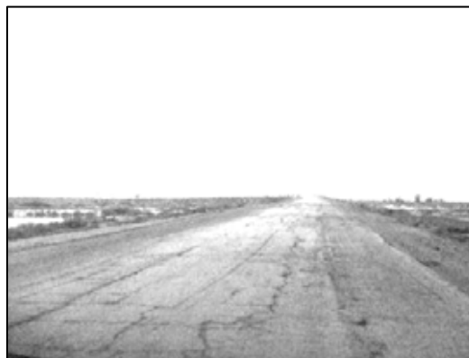
Поврежденная поверхность (возле Теджена)
