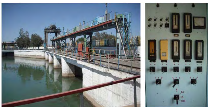
Рис. 2-15 Водозаборное сооружение на канале «Дустлик» (слева) и его щит управления (справа) Сентябрь 2008 г.
