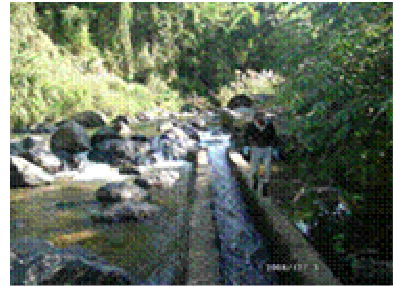
ລະຫວ່າງຈຸດເຂື່ອນ ແລະ ເຮືອນຈັກ, ມີຝາຍຊົນລະປະທານ ແລະ ຄອງເໝືອງຢູ່ທາງ ຝັ່ງຊ້າຍ. ບາງຂະນິດທົນກໍ່ຄືກັນນີ້ ຈະຖືກນຳໃຊ້ ສ້າງຄອງເໝືອງສຳລັບໄຟຟ້ານ້ຳຕົກ
