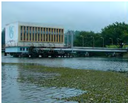
Foto 5.1.3 Plantas aquáticas no local de captação de água (02 / 09 / 2005)
