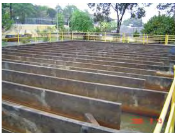
Foto 4.3.6 Poço de floculação
