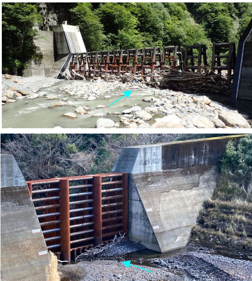
図 2.9.7 平常時に堆積した流木等による土砂堆積イメージ (上：平常時の流木閉塞事例、下：流木閉塞部に細粒土砂が堆積した事例)
