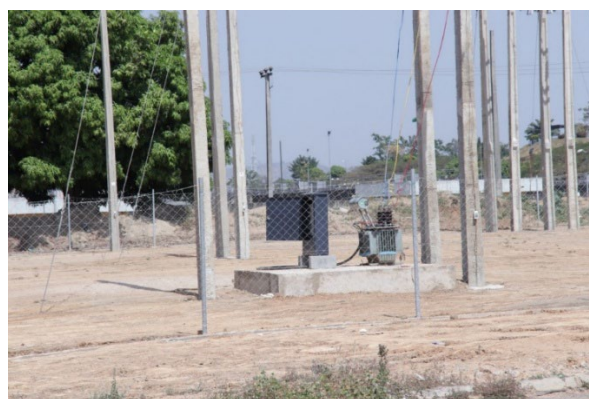
図 2-1-2.4 配電用変圧器と配電盤
