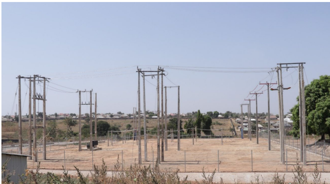
図 2-1-2.2 配電研修設備の全景
