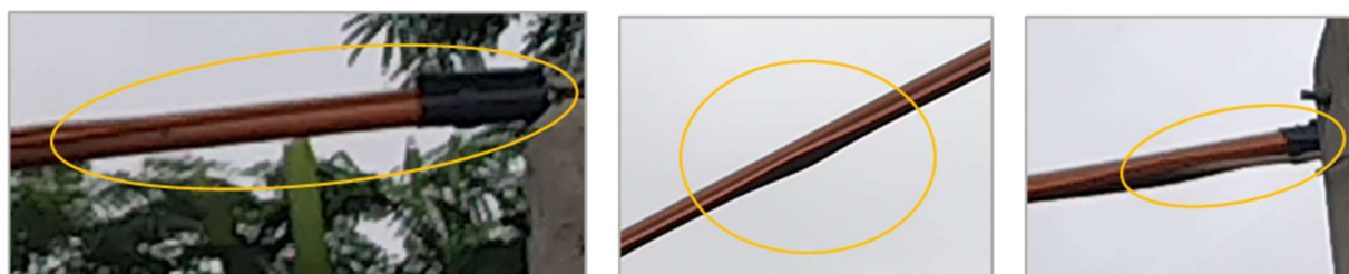
図 8 確認された施工不良
