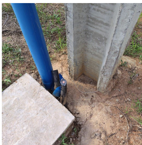
図 2-1-2.6 ケーブル立ち上げ部の盗難箇所
