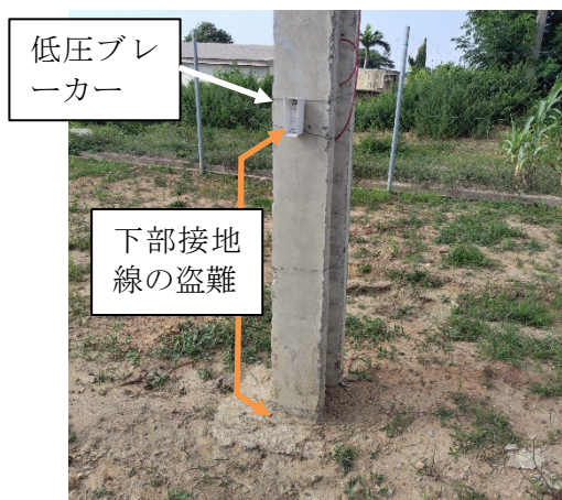
図 2-1-2.7 架空線事故点の下部接地線の盗難箇所
