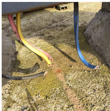
図 2-1-2.8 配電用変圧器と配電盤を繋ぐケーブルの盗難箇所
