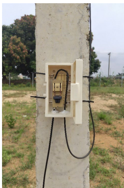
図 2-1-3-2.2 Fault point のブレーカー
