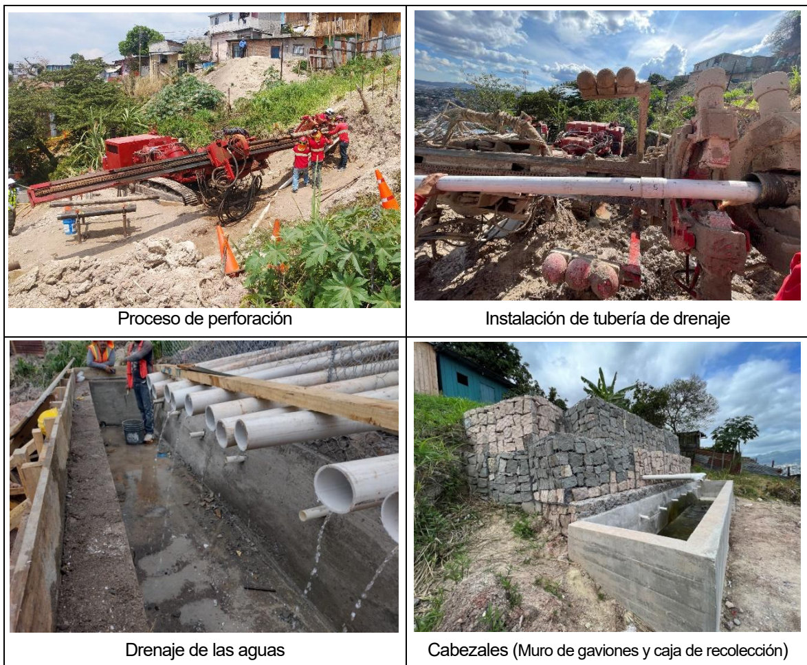
Figura 13 Fotos de caso de estudio de perforaciones para drenajes horizontales (en Campo Cielo)
