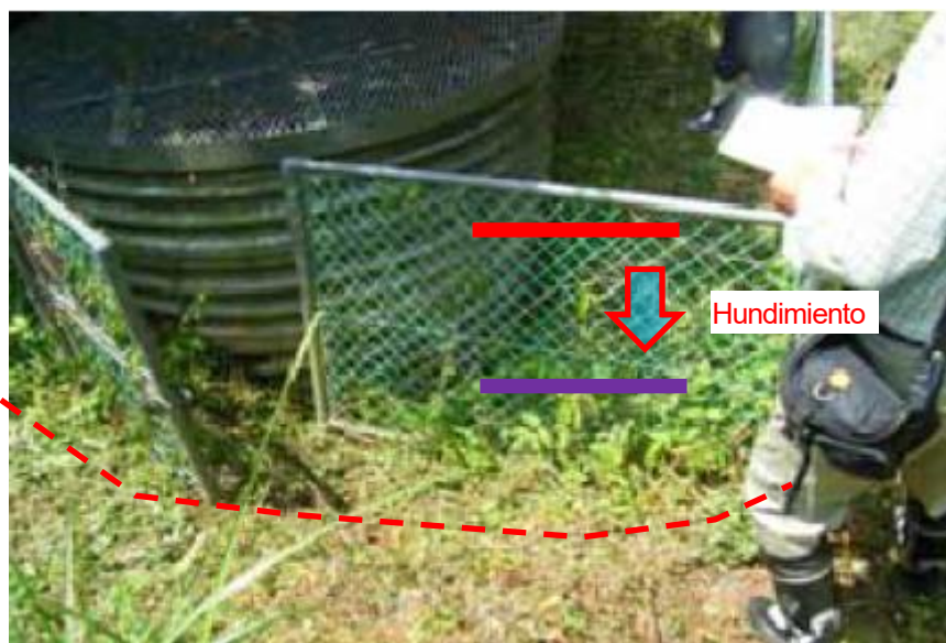
Hundimiento de la superficie del suelo y deformación de la valla de seguridad
