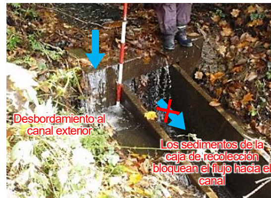
Desbordamiento por obstrucción
