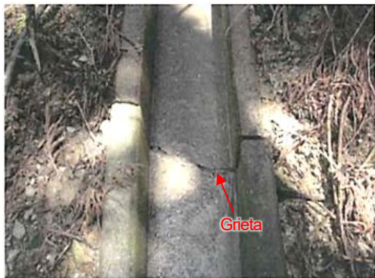
Grietas en canal
