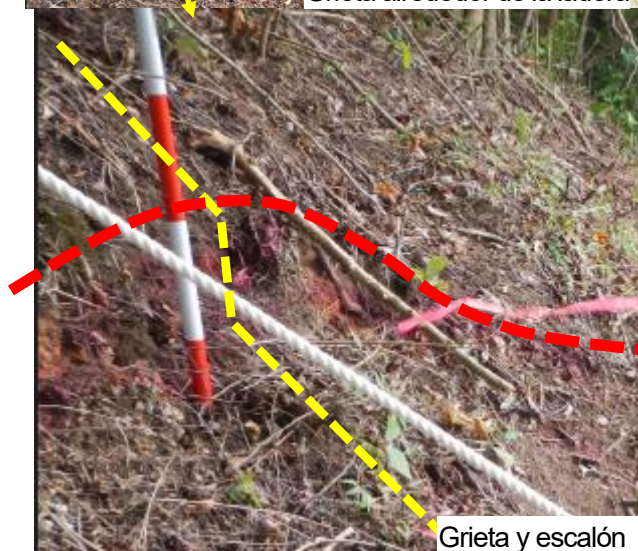
Figura 28 Imagen del esquema y fotografía de la deformación de la estructura causado por la actividad de la ladera
