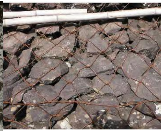
Canasta de gavión oxidado
