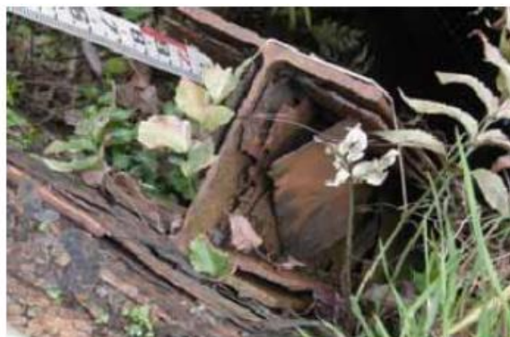
Corrosión de placas verticales de
