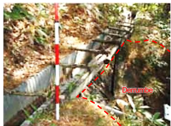
Derrumbe del talud bajo el canal
