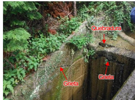
Grietas y quebraduras en dissipador de energía
