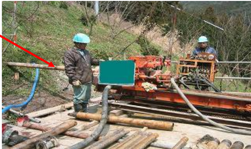
Figura 24 Ejemplo de posible accidente causado por tubería rotando
