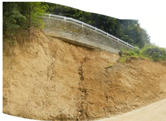
Suelo de cimentación erosionado
