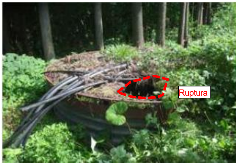
Deformacion de la rejilla protectora
