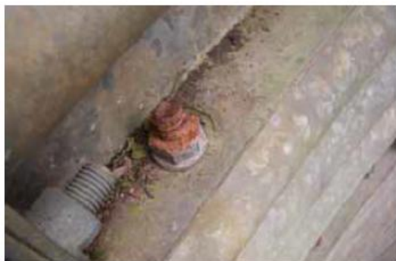
Corrosión en pernos
