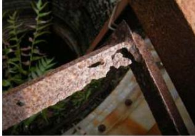
Deterioro debido a la corrosión (escalera)
