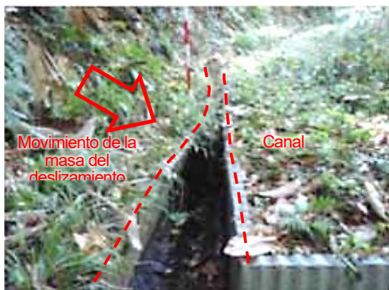
Deformación del canal debido al movimiento de la masa del deslizamiento
