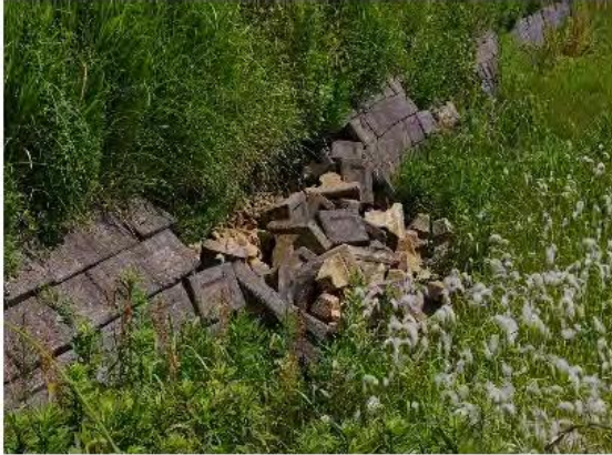
Muro de manpostería colapsada
