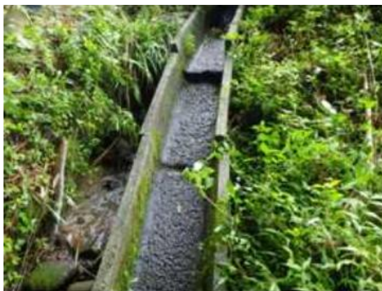
Hundimiento y volcamiento del canal
