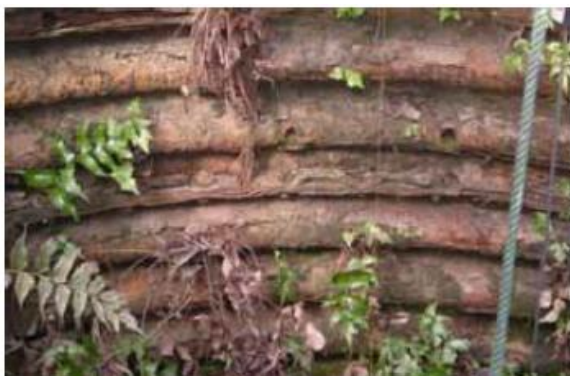
Corrosión en placa de revestimiento
