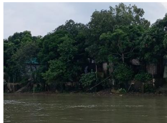
村落保護工未設置の村落外周部 (浸食の発生を確認)
