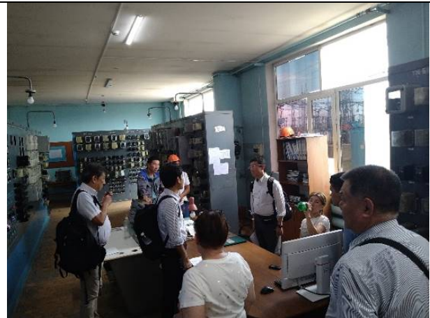
グラブナヤ 220 kV 変電所-1
