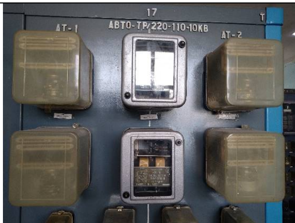
グラブナヤ 220 kV 変電所-2
