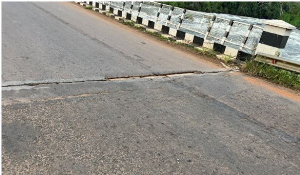
伸縮装置の損傷
