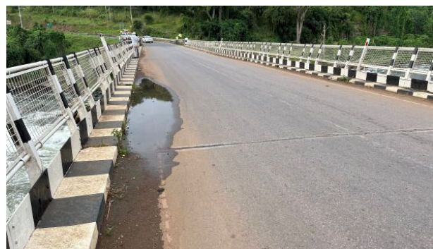
路肩に砂が溜まっていること、および排水樹が機能していないことによる水たまりの発生
