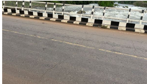
舗装の損傷（ひび割れ）
