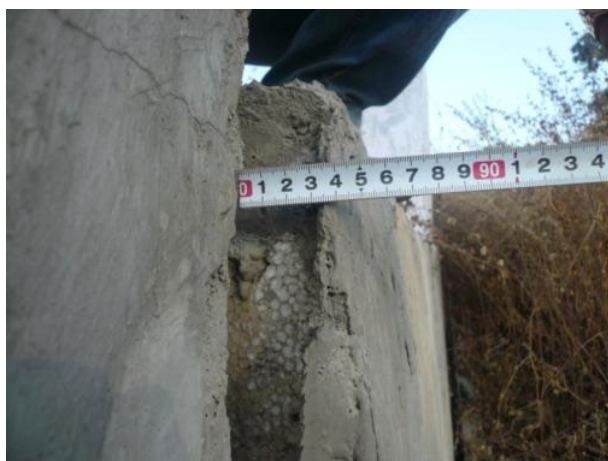
(c) 鉄道盛土のカルバート側壁の膨潤圧による変状 (インド)・乾期
