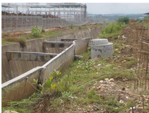
(a) 排水施設の被害(インドネシア)
