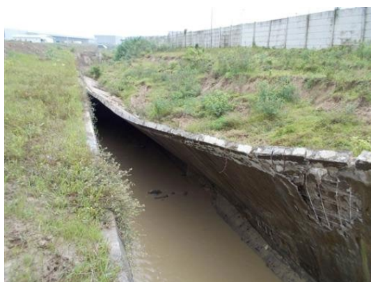
(b) 排水施設の被害(インドネシア)
