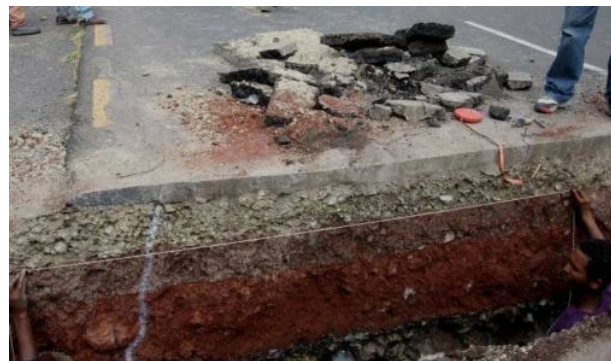
図 2.1.13 道路の被害事例(クラック)
