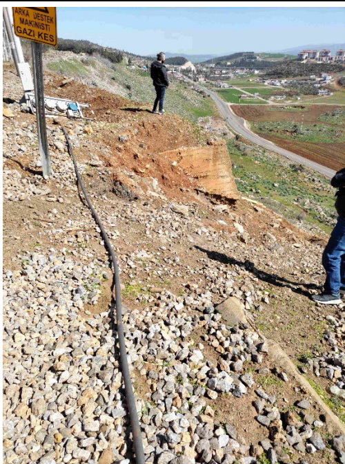
図 6-27 倒壊した土留め壁
