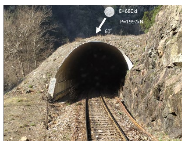
アーチカルバート 躯体のみ 落石
