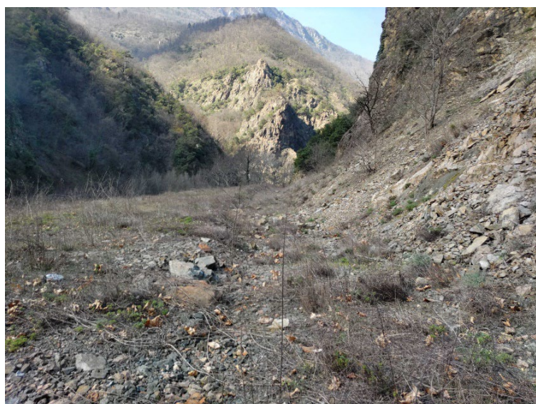
図 6-34 コルゲートトンネル上部の砂利にできた水みち
