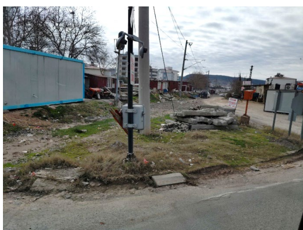
図 6-7 軌道が撤去された踏切隣接部
