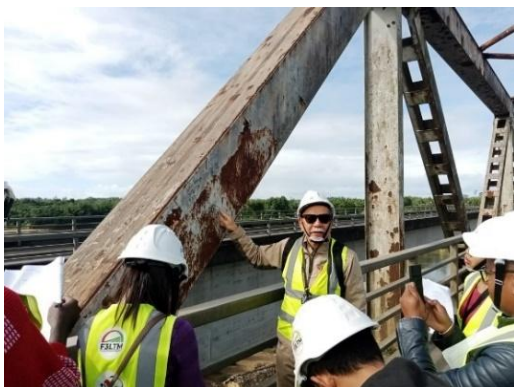
Photo 1 Explication des dégradations des couches de peinture du pont métallique et de ses causes probables
