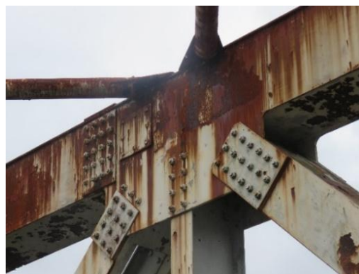
Photo 2 Dégradations des couches de peinture et corrosions en développement
