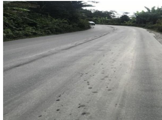
Fluidification de la chaussée (orniérage : PK 163+800)
