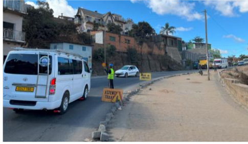
Mesures de sécurité pendant les travaux de réparation (régulation du trafic, panneaux d'information)
