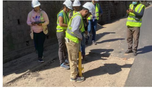
Confirmation de la valeur CBR de la couche d'assise à l'aide de l'équipement fourni (marteau de Clegg)
