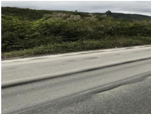
Fluidification de la chaussée (orniérage : PK 144+400)
