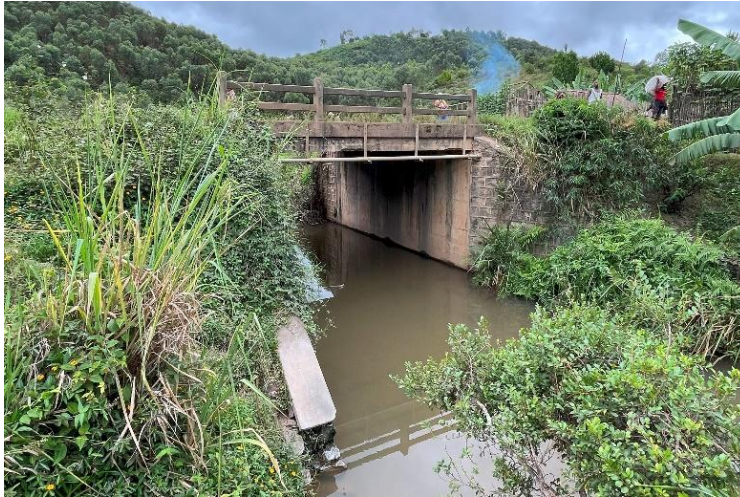
Photo 2 Pont où il n'existe pas de lit majeur au-dessous de ses poutres
