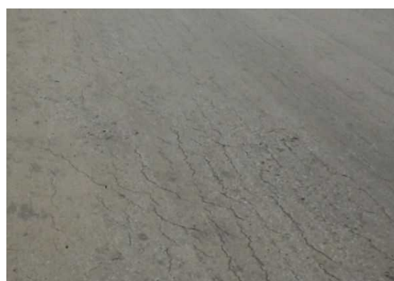
橋面(床版)の橋軸方向ひび割れ
