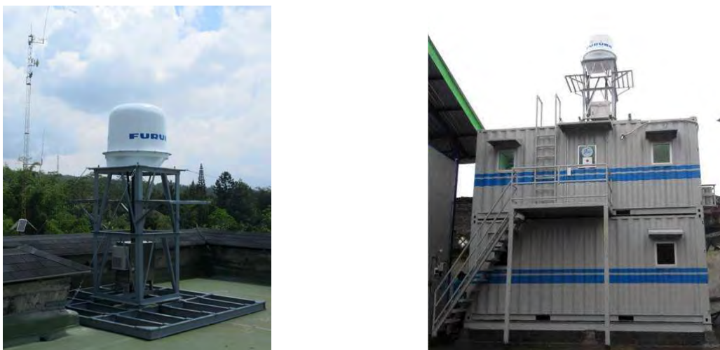
図 2-5 XバンドMPレーダー設置状況
