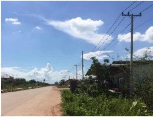
ສາຍໄຟຟ້າ 22 KV
