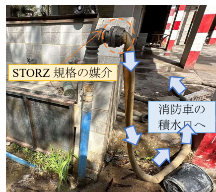
写真 2-12 消防署内の消火栓
