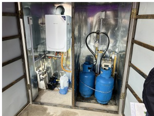
ガス給湯施設 給湯器とボンベ室に分かれる。14kg ボンベ2本
