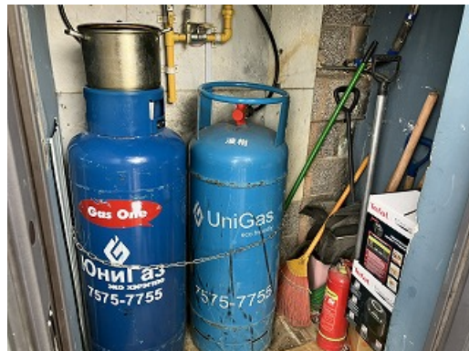
レストランでの LP ガス利用 メーターによる残圧管理はなく、供給事業者により定期的にボンベが補充される（1本ずつ）
