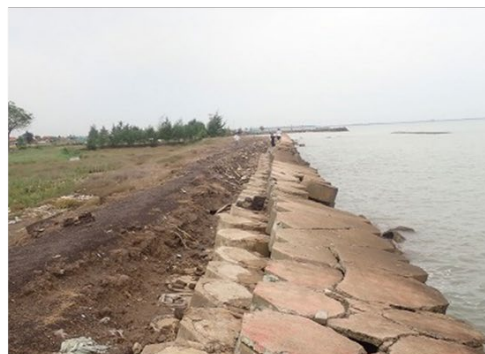
Runtuhnya Seawall karena erosi lebih lanjut
