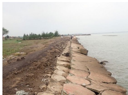
侵食の進行による護岸の倒壊
