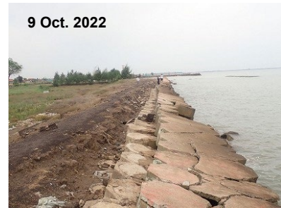
前面侵食の進行による護岸崩壊(P1)
