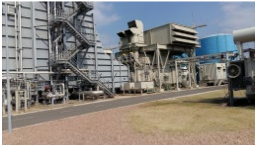
マプト火力発電所 GT
