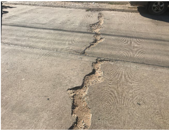
図 3.31 サバナケット市内の街路のコンクリート舗装（ひび割れ）
