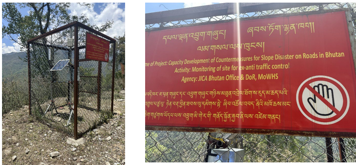
図4.45 JICA技術協力プロジェクトで設置された気象観測装置 223
