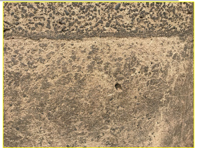
図 3.53 日ラオス友好橋のコンクリート表面接写
