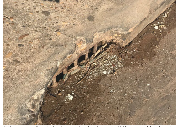
図 3.30 サバナケット市内の国道 9W 線路肩の排水呑口
