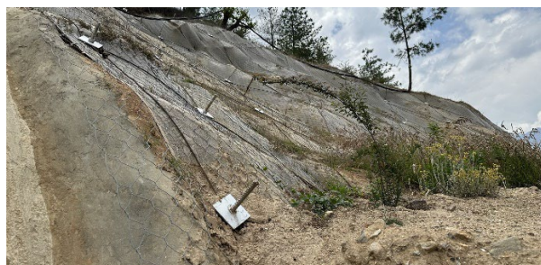
図 4.27 斜面のアンカー工（Thimphu 市内） 124
