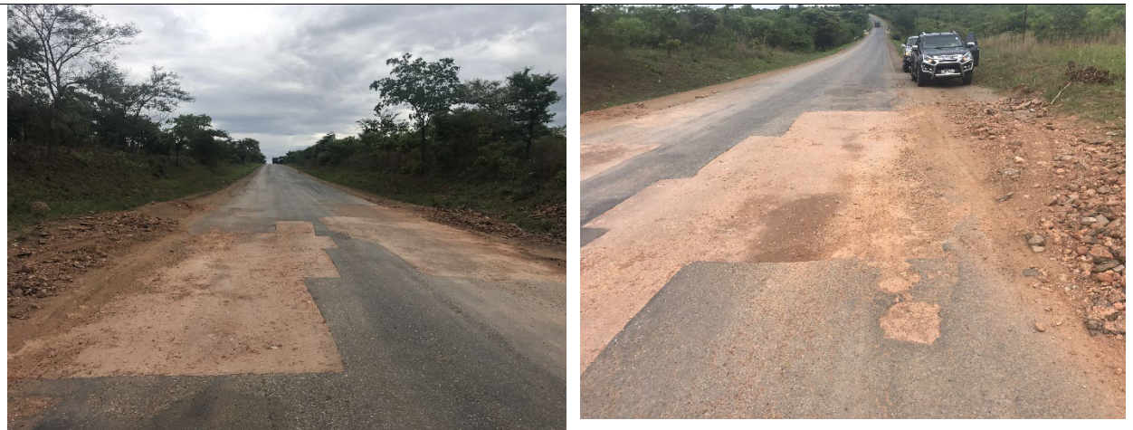
図 6.31 応急措置が施された舗装の状況 (T4:Lusaka-Rufunsa: Rufunsa Fisheries 付近) 433
