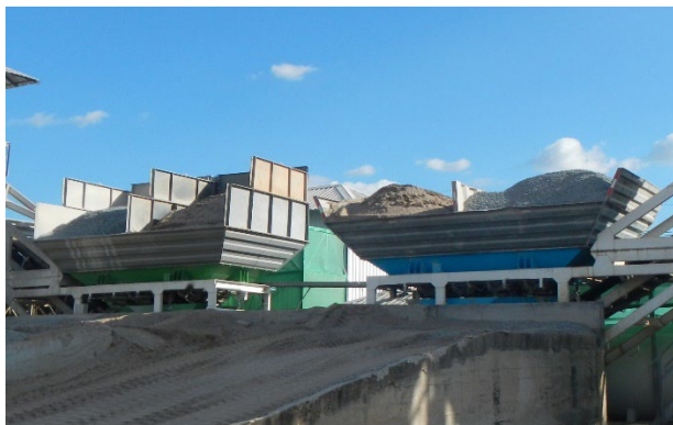
図 3.44 タイ製の生コン製造装置の骨材搬入口
