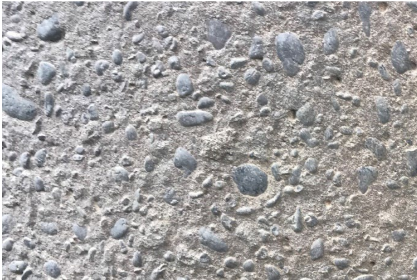
図 3.48 旧ベイリー橋の橋脚表面の接写
