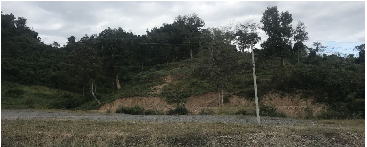
図 3.64 メコン川沿いの街道のり面（タイ支援プロジェクトフェーズ2）のり面遠景
