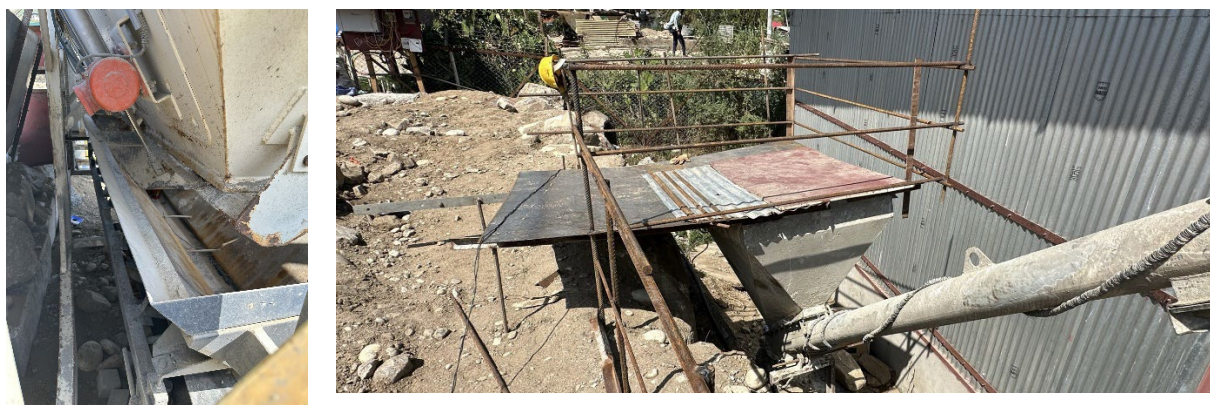
図 4.43 移動式の生コンクリート・プラントの管理状況（GOIプロジェクト） 220
