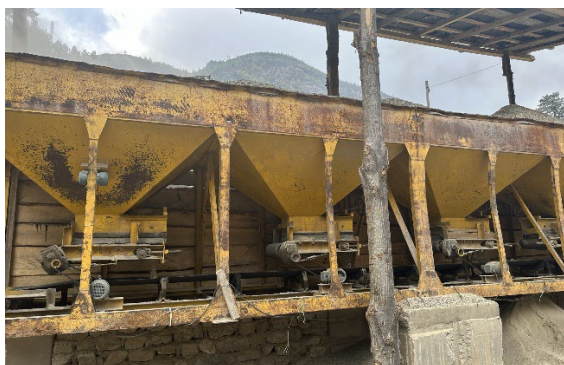
図 4.34 仕切り板のないホッパーと計量装置 188
