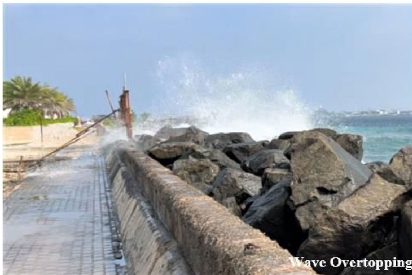
写真 D-1-5 東海岸のモスクの南側の越波の大きい区域 (出典：マレ首都圏気象災害情報収集・確認調査団撮影)
