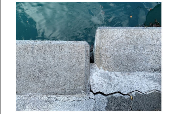
写真 5-3 : 北岸壁。頂部コンクリートブロックのズレが確認できる。
