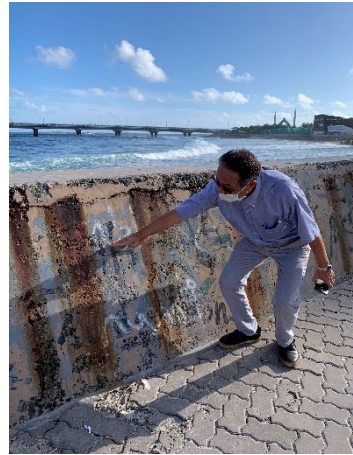
写真④-1： 護岸上部の全域に劣化確認、背後歩道への越波確認。 延長約 68m （2022/10/25 撮影）
