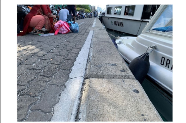
写真 5-1 : 北岸壁。頂部コンクリートブロックのズレと傾きが確認できる。
