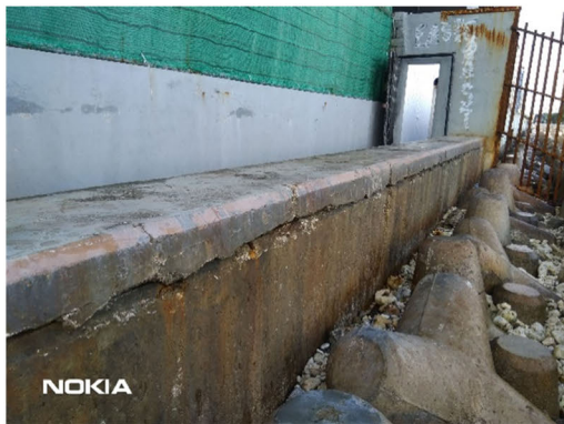
写真 1-1：A区域。上部工の劣化・損傷が確認される。
