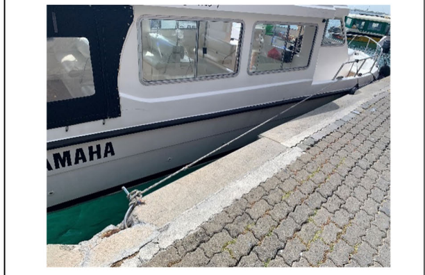
写真 5-4 : 北岸壁。損傷した係船柱を使用している。
