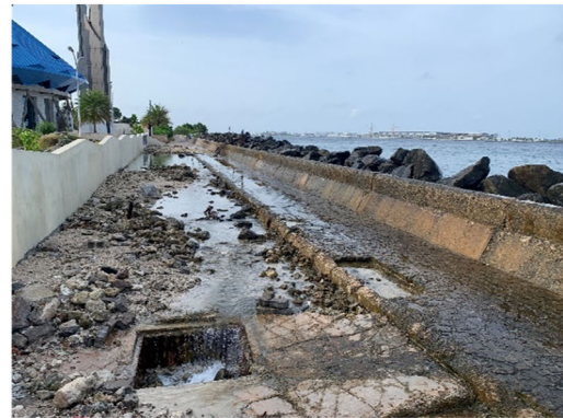
写真 3-2：C区域。越波後、水が溜まっている。
