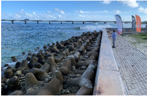
写真③：護岸上部の劣化が確認され、背後の歩道へ多少の越波を確認（護岸上部の濡れ）約 35m。 （2022/10/25 撮影）
