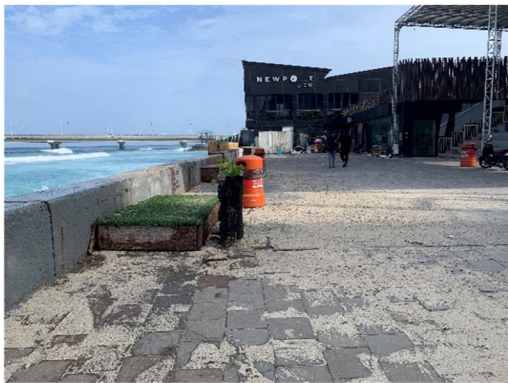
写真 1-3：A区域。越波により後背地には砂が溜まっている。
