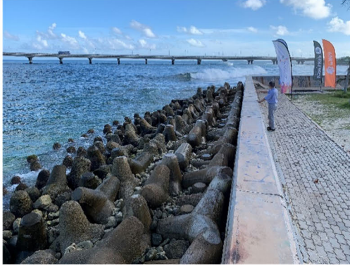
写真 2-2：B区域。消波ブロックがズレて沈下し、隙間に砂礫が溜まっている。
