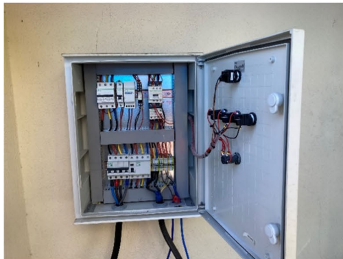
写真 1-3：雨水排水ポンプ既設配電盤(LS09)
