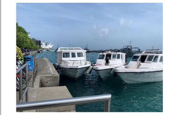
写真 5-5 : 北岸壁。係船柱が破壊しているため、手すりを代用している。
