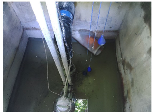
写真 1-4：雨水排水施設タンク内部 (LS16、フロートスイッチ及びポンプ)
