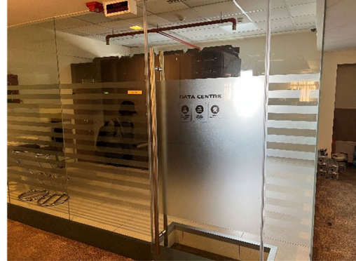
写真 2-2：サーバールーム（MWSC）
