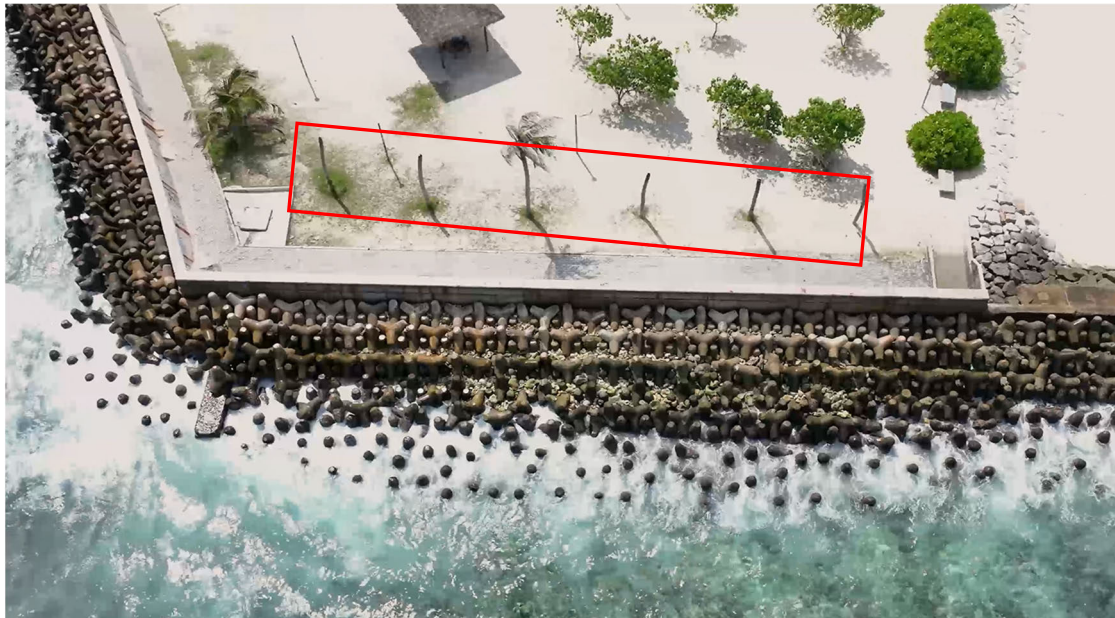
写真④-2: 護岸背後の植生が枯れていることが確認できる。（赤枠部分）
