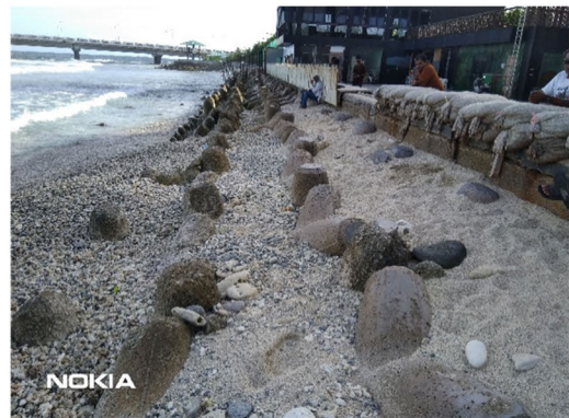
写真 1-2：A区域。越波防止の応急処置として木柵（奥）と土嚢（手前）が設置されている。
