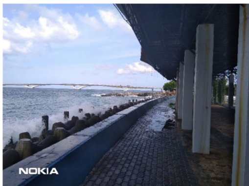
写真 4-1：D区域。消波ブロックがズレて沈下し、越波した水が溜まっている。
