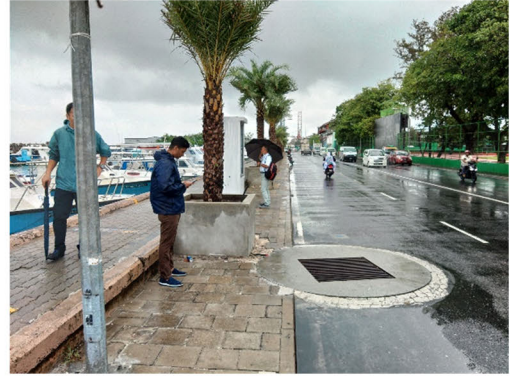
写真 1-2：雨水排水ポンプ施設全景(LS05)。雨水タンクが車道の下に設置されている。
