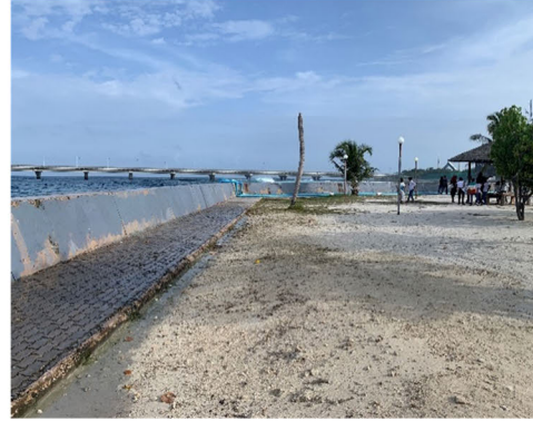
写真 2-2：B区域。後背地の植物が、越波の影響により枯れている。
