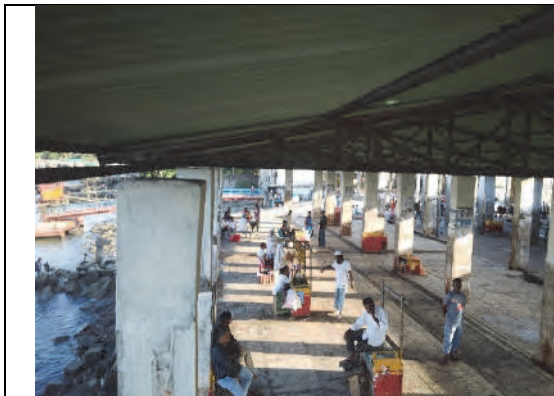
写真 1-4：荷捌所 (A) の柱上部
