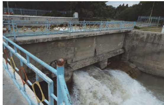
1) Zapadnyi 頭首工 チュイ州 2 層取入れ水路（上部取水路、下部排砂路）
