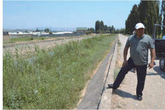
コンクリートライニング水路内の堆砂 ジャララバード州
