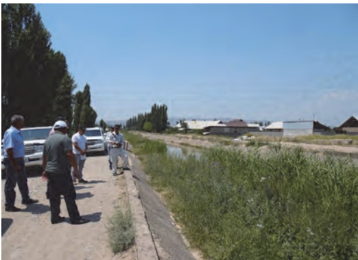
写5 土砂が堆積し葦が茂った州事務所管轄の水路 (ジャララバード州)
