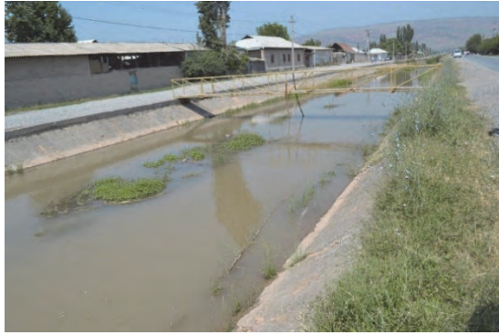
コンクリートライニング水路内の堆砂 ジャララバード州
