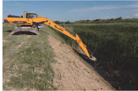
ロングリーチエクスカベータによる 排水路浚渫・掘削作業（チュイ州）
