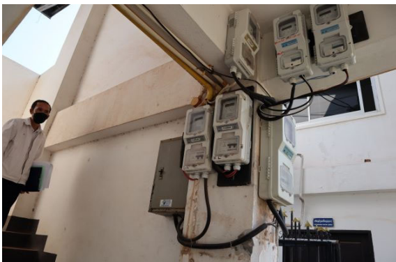
写真 47: ③引き込みポイント各戸メーター
