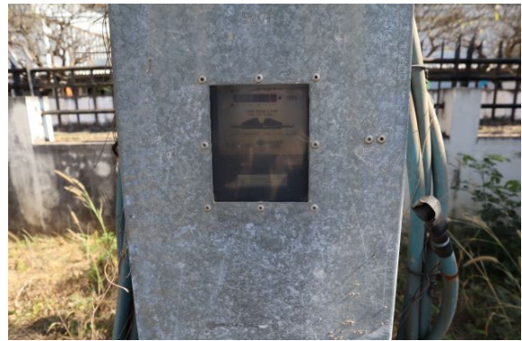
写真 44: 電気メーター
