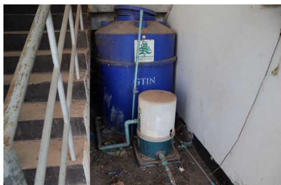
写真 57: 給水タンクと送水ポンプ
