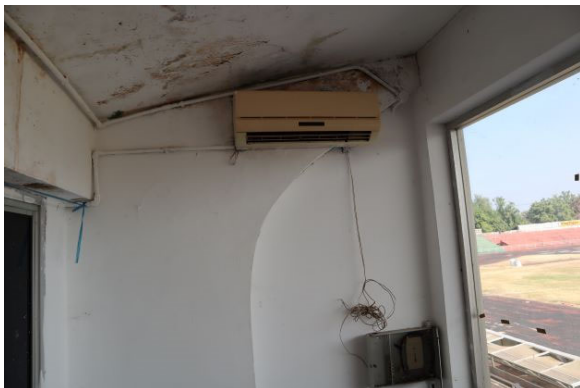
写真 8:シェッド上裏の錆汁浸みだし
