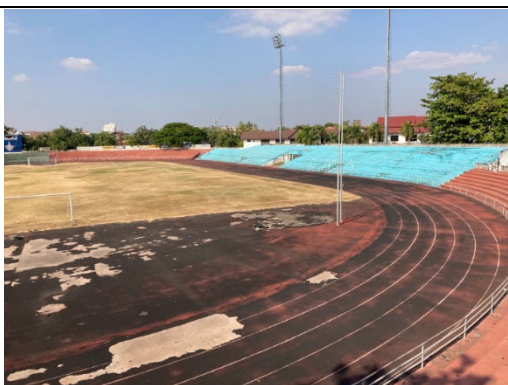
グラウンド遠景 走行レーンは直線部9、カーブ部6 陸上トラックの破損が目立つ
