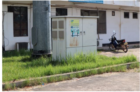
写真 50: 照明塔用キュービクル
