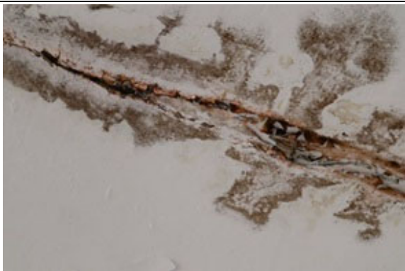
バックスタンド下 コンクリートの中酸化が進んで鉄筋が腐食することで、 コンクリートが剥がれ落ちている
