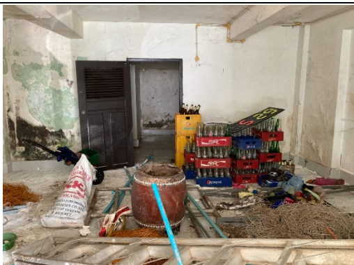
メインスタンド建物1階 補修資材等の物置となっている
