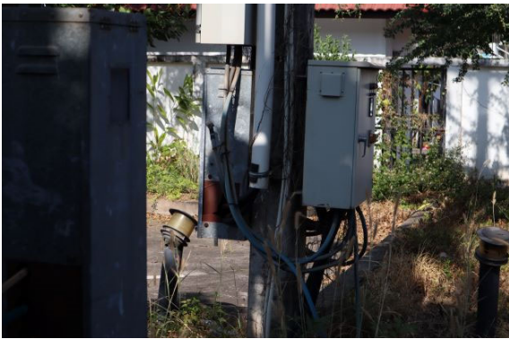
写真 43: 受電盤及び電気メーター
