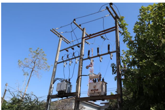
写真 39: ①市内高圧線引き込みポイント
