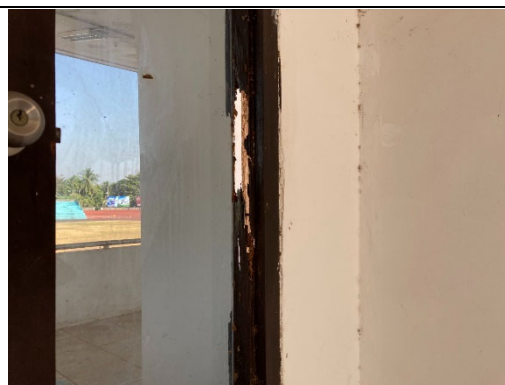
メインスタンド建物 扉の木枠には損傷が多くみられる
