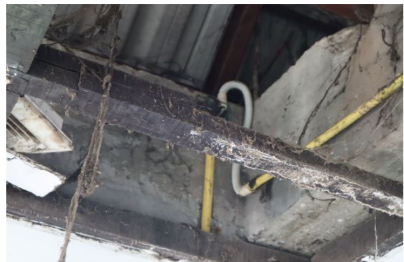
写真 54: メインスタンド天井裏配線
