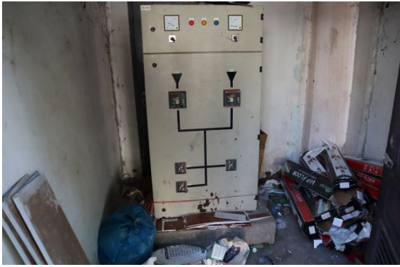
写真 49: ⑤スタジオ照明塔用分電盤
