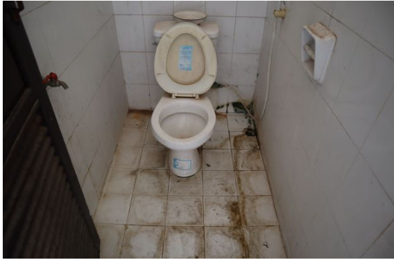
写真 59:メインスタンド VIP ルーム便器
