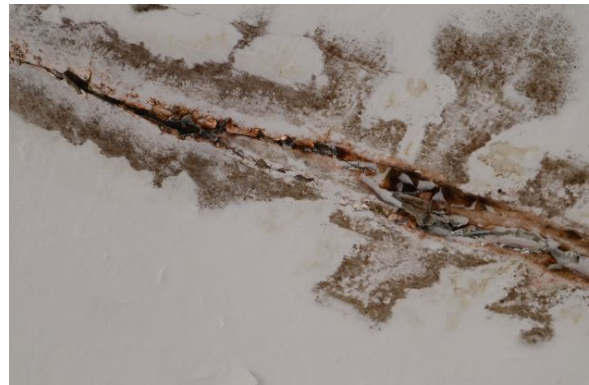
写真 7:鉄筋爆裂部分拡大(2)
