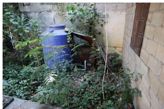
写真 58: FRP給水タンク
