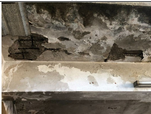
サイドスタンドスラブ下 コンクリートの中酸化が進んで鉄筋が腐食することで、 コンクリートが剥がれ落ちている
