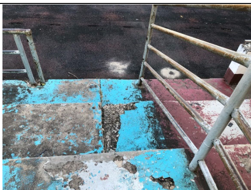
メインスタンド客席通路部 床面は所々剥がれている
