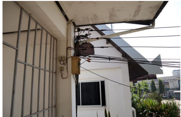
写真 46: ③電力引き込みポイント
