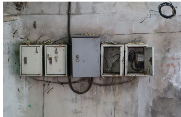
写真 52: ④電力引き込みポイント⑦盤
