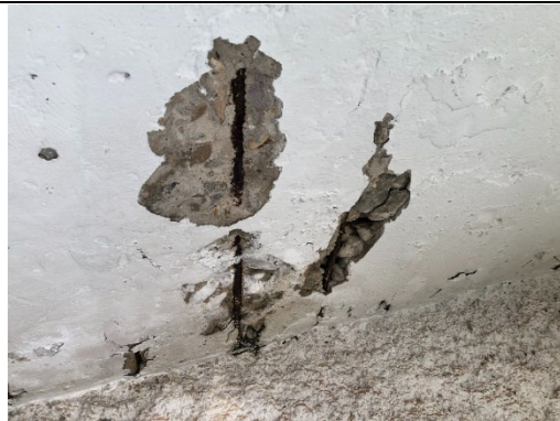
バックスタンド下 コンクリートの中酸化が進んで鉄筋が腐食することで、 コンクリートが剥がれ落ちている
