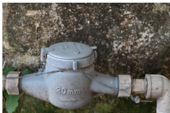
写真 56: 給水ポイントの 20 mmメーター
