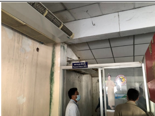
バックスタンド下 スポーツ協会事務所として利用している 場所によっては雨染みがありカビの臭いがする
