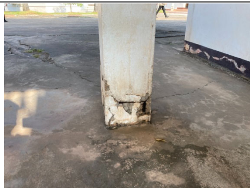
バックスタンド柱脚 コンクリートの中酸化が進んで鉄筋が腐食することで、 コンクリートが剥がれ落ちている
