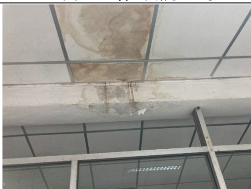
バックスタンド下スポーツ協会事務所 天井に雨染みがある。部屋全体にも カビの臭いが充満している
