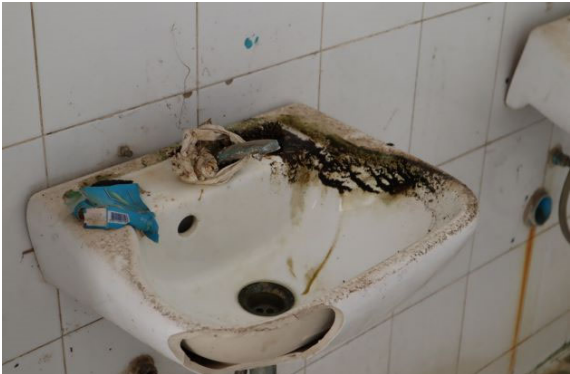
写真 61:メインスタンドトイレ洗面器 (1)
