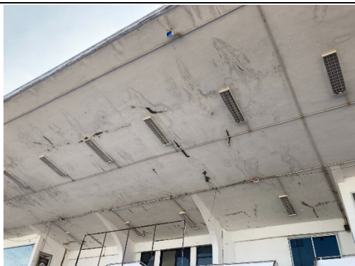
メインスタンド屋根 ひび割れが多く、一部鉄筋が露出している スラブ状ではね出し幅が大きい
