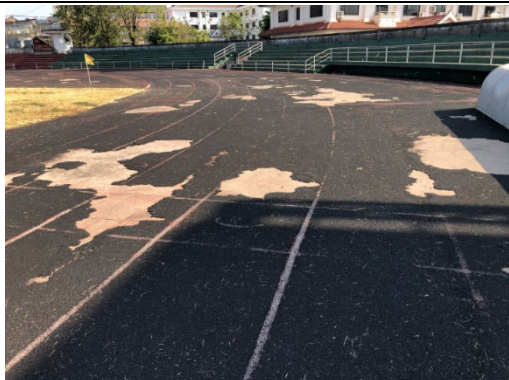
陸上トラック トラック舗装の損傷が激しく、 コンクリートスラブがむき出しになっている
