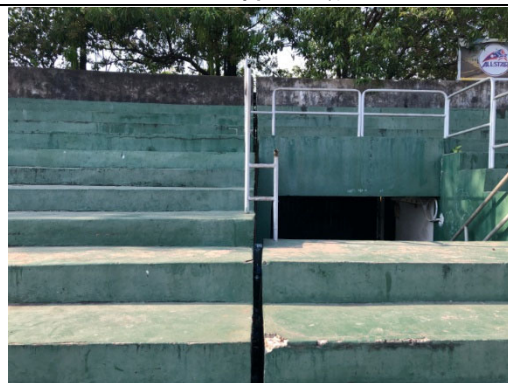
サイドスタンド ある程度の距離で躯体を縁切りしているが、 場所によってはくっついている
