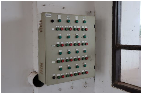
写真 51: ⑥メインスタンド分電盤
