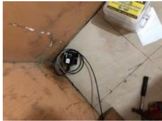
21. IT 震度計設置状況 (パテロス、MDRRM 事務所)
