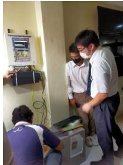
16. IT 震度計設置状況 (ロスバニョス DOST-Calabarzon 支所)
