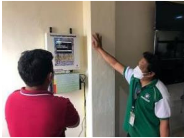
13. IT 震度計設置状況 (ロスバニョス DOST-Calabarzon 支所)
