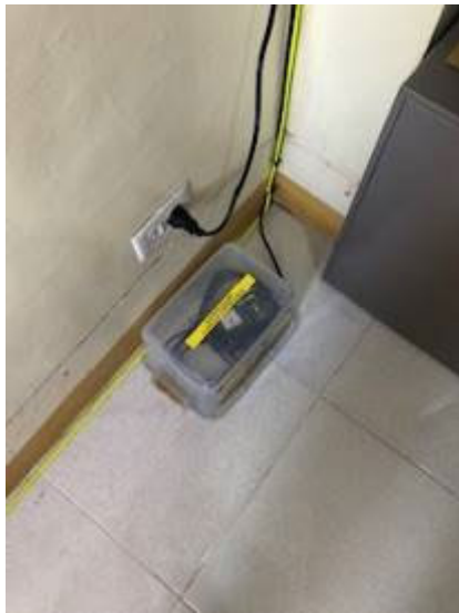
15. IT 震度計設置状況 (ロスバニョス DOST-Calabarzon 支所)
