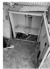
写真2 観測局筐体中
