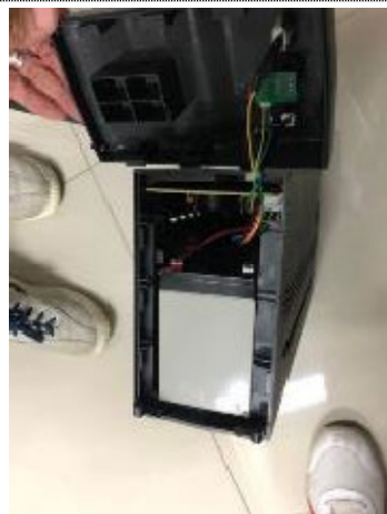
12. IT 震度計 UPS バッテリー交換作業状況 (マニラ PHIVOLCS 本部)
