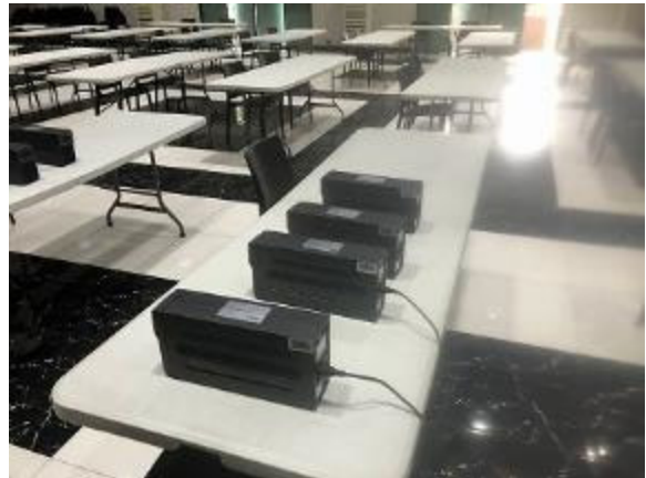
10. IT 震度計 UPS 動作確認作業状況 (マニラ PHIVOLCS 本部)
