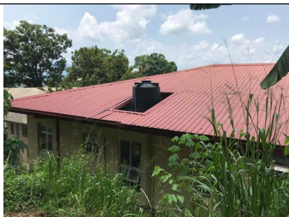
ラトナプラ教育病院（血液バンク棟） メンテナンスはされておらず、高圧洗浄と塗装が必要である。貯水タンクを避けて太陽光パネルを設置する。
