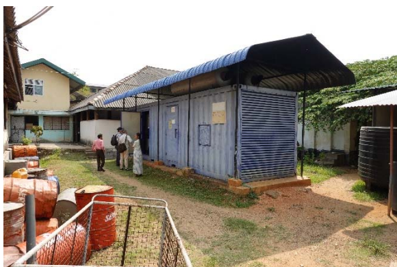
図 2.6 非常用発電機コンテナの写真
