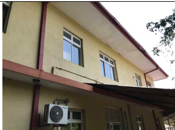
ラトナプラ教育病院 (血液バンク棟) 外部躯体状況。ひび割れも無く良好な状態である。
