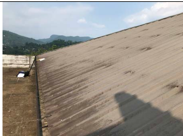
ラトナプラ教育病院 (事故救急救命棟) 既存の金属折板屋根状況。メンテナンスはされておらず、錆びているビスがある。高圧洗浄と塗装が必要である。
