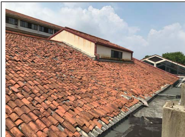
スリジャヤワルダナプラ総合病院 (B棟) B棟の屋根瓦の状況。経年劣化により瓦が割れ、はがれ落ちている。
