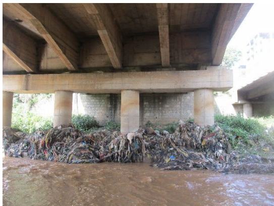
橋脚まわりに堆積したごみ（新橋）
