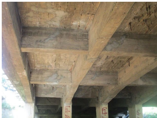
床版の遊離石灰、補修跡（旧橋）
