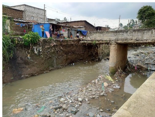
被災橋梁全景 (2)
