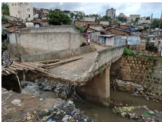
被災橋梁全景 (1)
