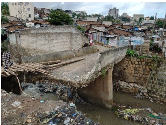
被災橋梁全景 (1)
