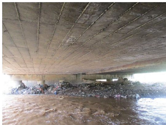
中央径間床版のエフロレッセンス
