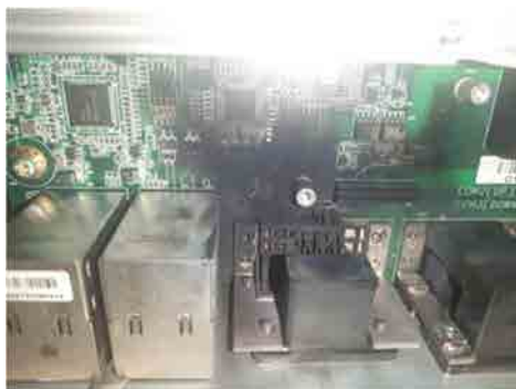
EDP 外部標示器コネクタ焼損
