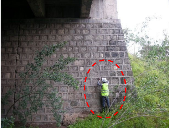
ノギスを使つてのひび割れ計測
