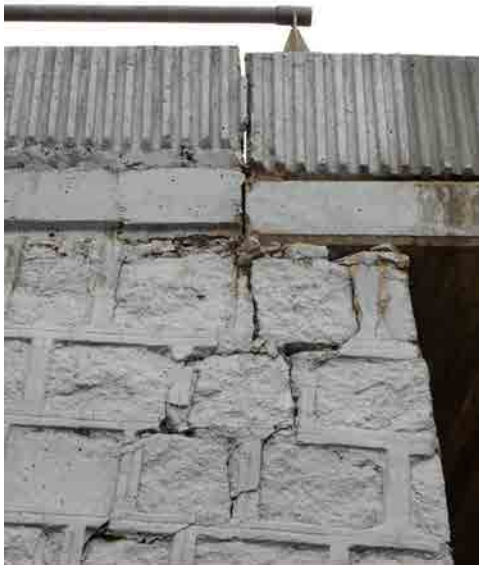
壁高欄の高さのずれ (A2)
