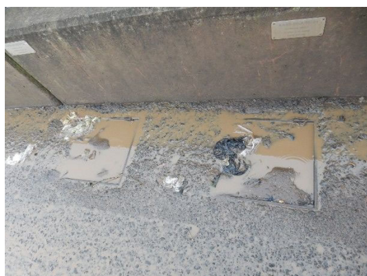
排水柵の詰まり
