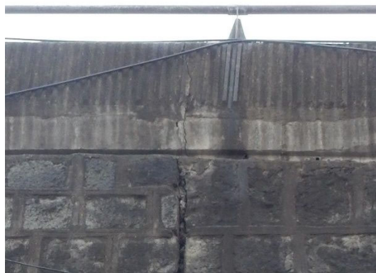
路面脇壁高欄の損傷（外側）
