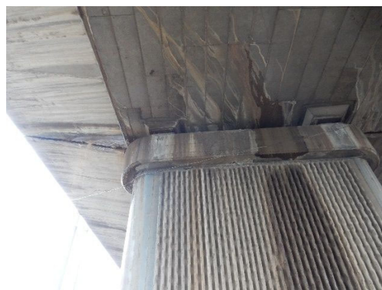
架け違い部 (P1漏水箇所)
