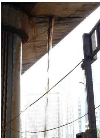
激しい漏水 (P1)
