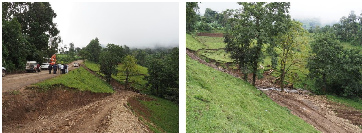
道路盛土の状況。地すべり頭部は左手の森の中と思われるが、盛土部分からすべっている可能性もある。
