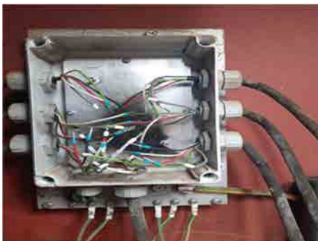
ターミナルボックス基板を外した状態
