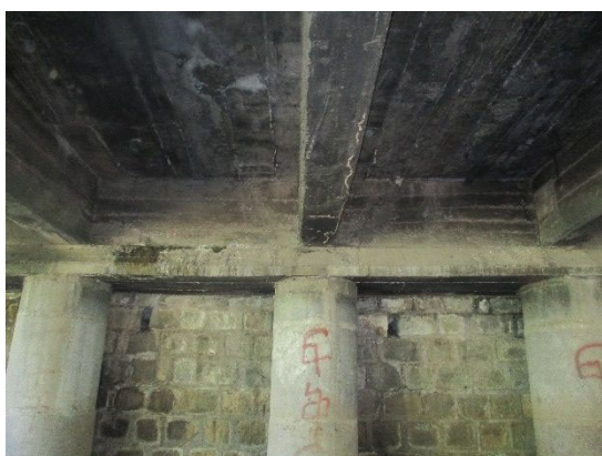
床版の遊離石灰、漏水跡
