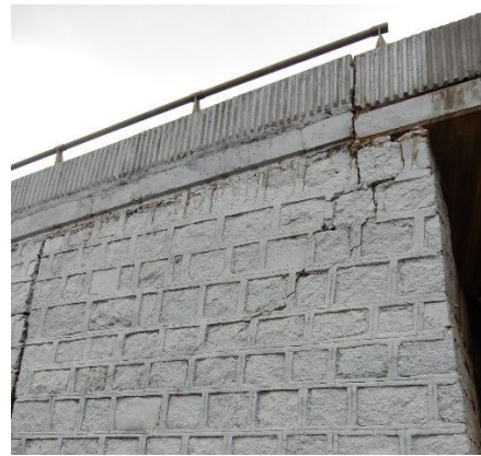
A2側面石積み工のクラック
