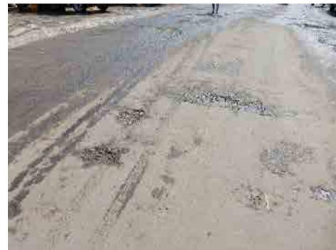
路面 (ポットホール)
