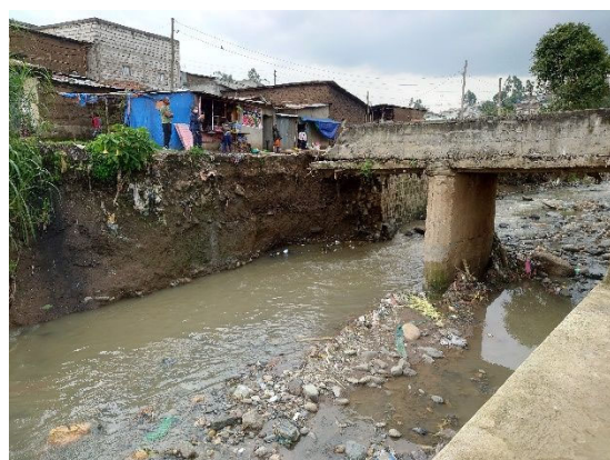
被災橋梁全景 (2)
