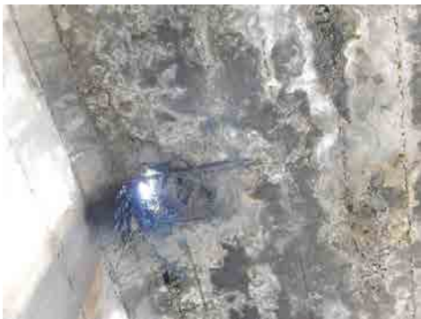
RC床版下面 (鉄筋露出)
