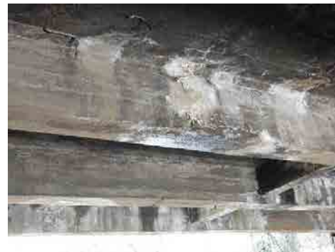
RC桁 (クラック、水漏れ)
