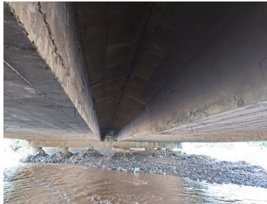
橋脚まわりに堆積したごみ
