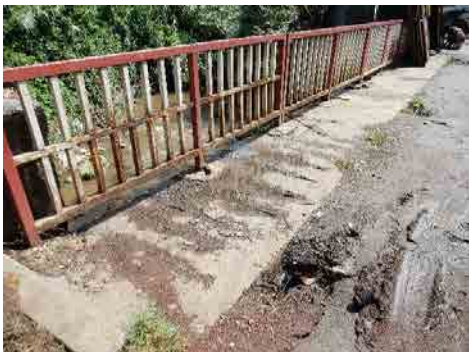
橋面 (路面損傷、滞水)
