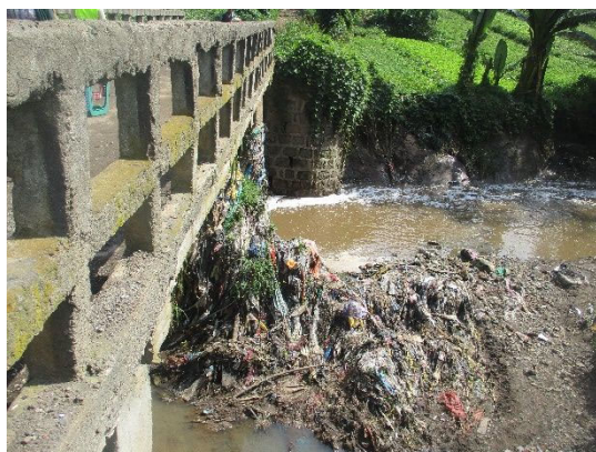
橋脚まわりに堆積したごみ
