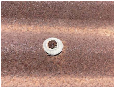
(d) Corrosion of existing nails
