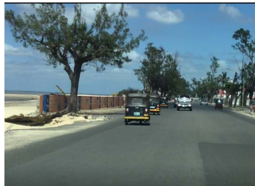
堤防崩壊による路肩欠損箇所
