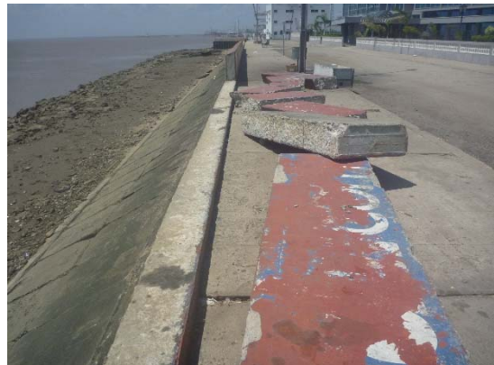
⑧ 港付近の防潮堤（パラベット）の崩壊
