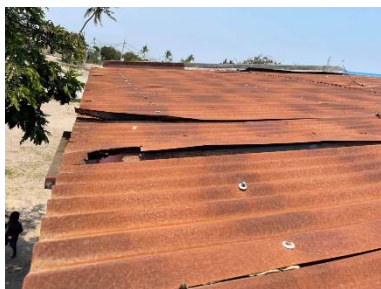
(a) 根材の変形・割れ
