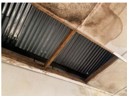
(a) 腐食している天井材
