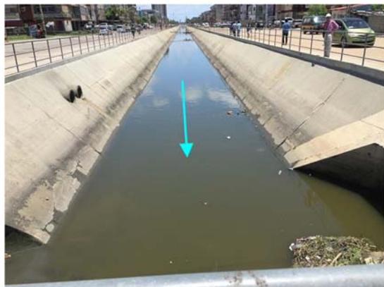
③ 開水路に損傷はない
