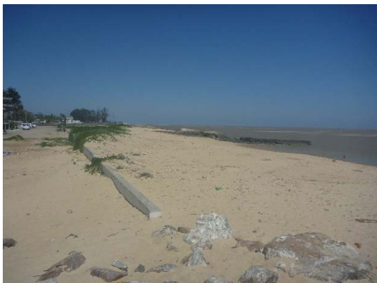
⑤ 突堤：老朽化。波浪作用による被害
