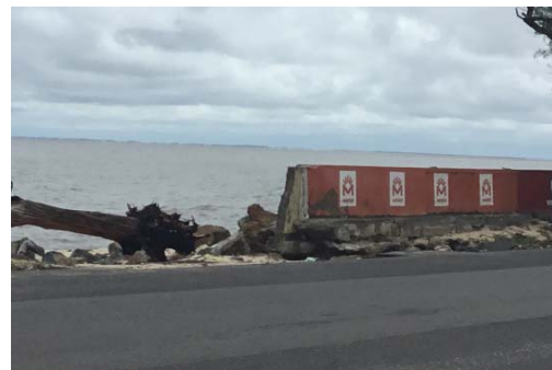
堤防崩壊による路肩欠損箇所
