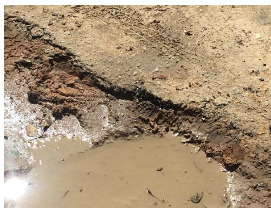
ポットホールで表層が欠損した箇所。路盤材が確認できず、アスファルトのみである可能性がある。
