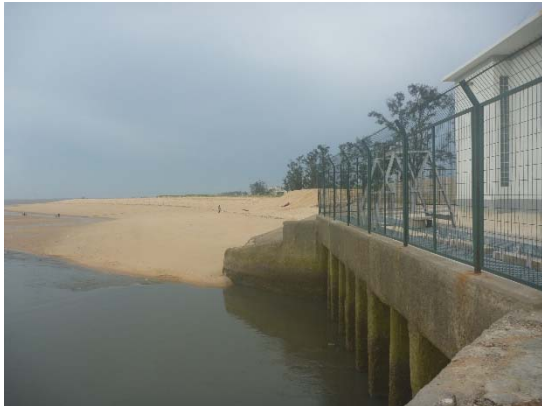
③ 水門海側部分は損傷なし
