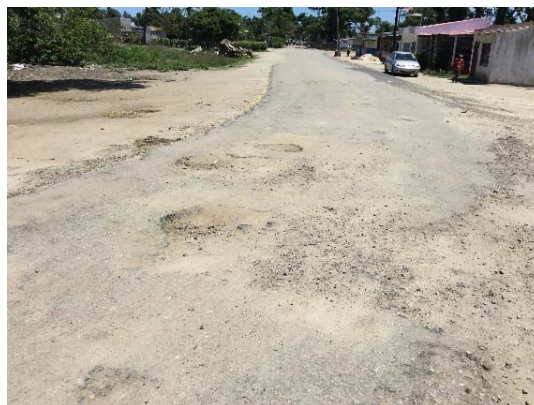
チングスーラ： 舗装の劣化が進み多くの表層が欠損している
