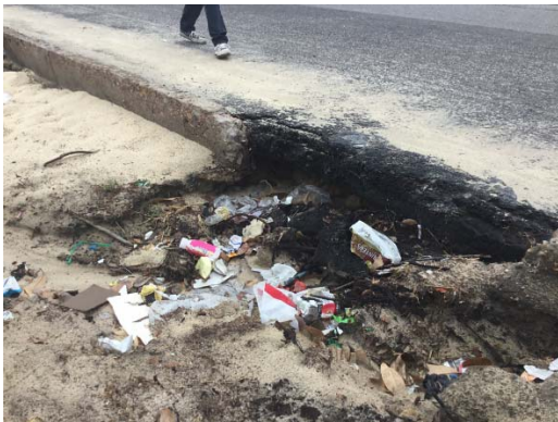
舗装止めの崩壊箇所
