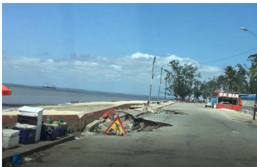
堤防崩壊による路肩・歩道欠損箇所
