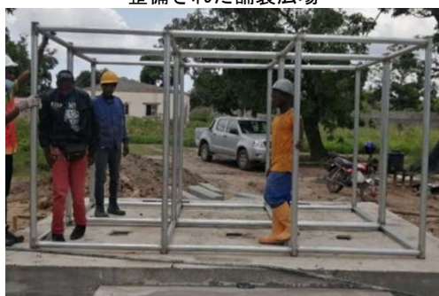
災害時に利用可能な仮設トイレ
