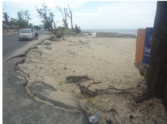
② 防潮堤の破堤、背後道路の崩壊
