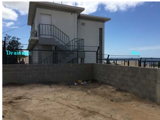
⑥ 水門施設にも損傷はない
