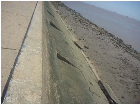
⑦ 護岸部の空洞化
