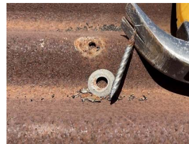
(e) 釘の腐食
