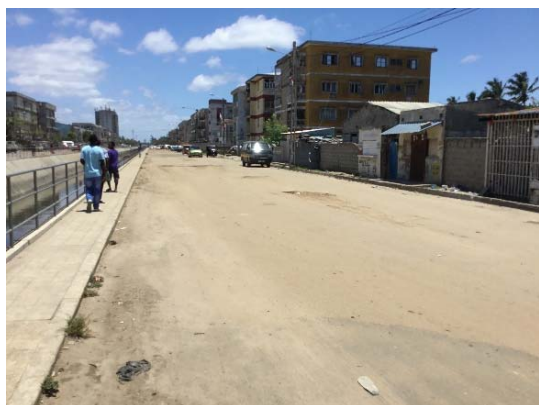
Avenida 24 通りの舗装状況 複数のポットホールがある
