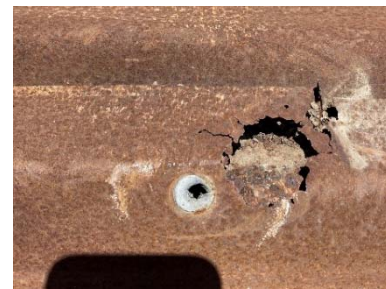
(f) 屋根の腐食
