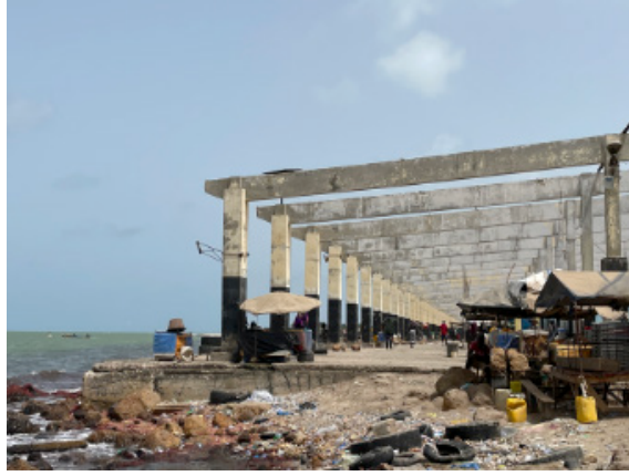
Photo 1 : Coin du côté droit de l'installation existante (juin 2023)
