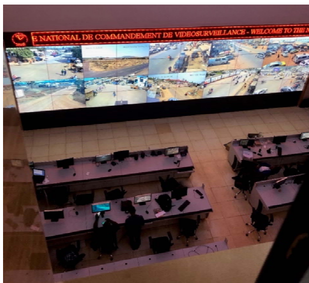
図 5.3.1 セキュリティ監視システム管制センター
