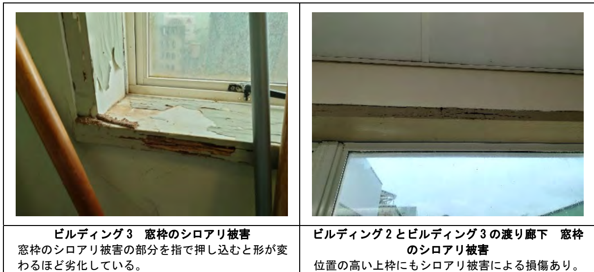
図 2-14 シロアリ被害 写真
