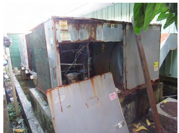
ビルディング 3 2代目大型パッケージ ビルディング 3の残りの1台は手術室用の大型パッケージで、2代目の機器である。外観上はほとんど朽ち果てているが、何とか稼働している。
