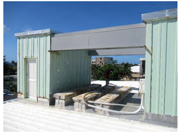
ビルディング-1 大型パッケージ撤去跡 修繕要請があった時にはビルディング 1の屋上に2階用の大型パッケージ(2代目)が2台設置されていたが、現在は撤去されている。
