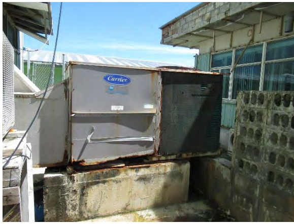
ビルディング 1 大型パッケージ ビルディング-1には1階空調用として2台の大型パッケージ(2代目)が設置されているが、かなり腐食が進んでいる。
