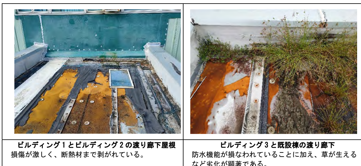
図 2-5 渡り廊下 屋根からの雨漏り写真
