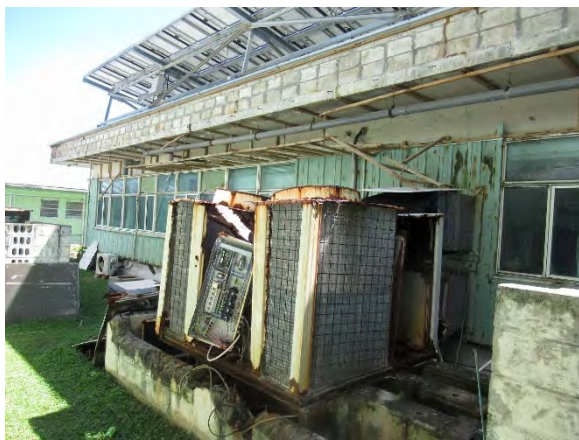
ビルディング 2 大型パッケージ ビルディング 2とビルディング 3用の3台の2代目大型パッケージがあるが、故障して放置されている。これらのエリアでは病院側が設置したルームエアコンによって空調が行われている。
