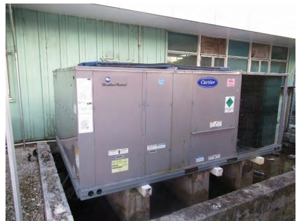
ビルディング 3 大型パッケージ ビルディング 3には4台の大型パッケージが設置されており、うち3台は2022年初頭に病院側の工事により更新されている。この機器は3代目である。
