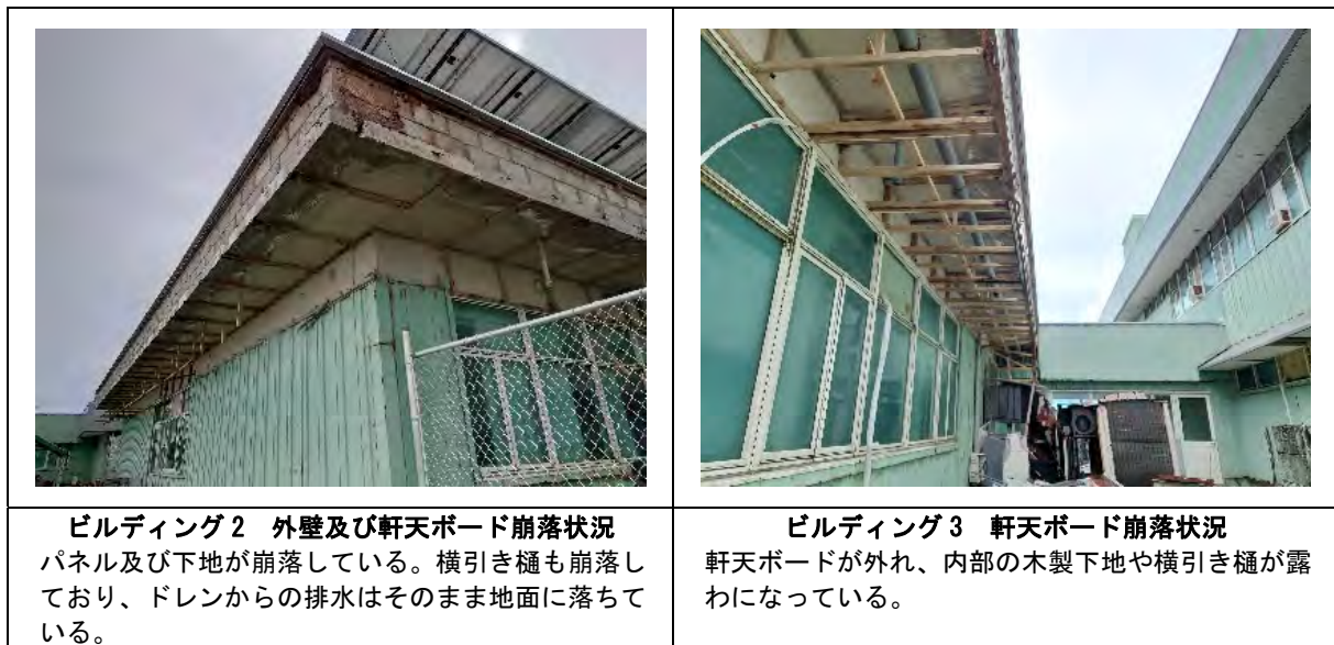
図 2-13 外壁パネルおよび軒天の劣化・落下 写真
