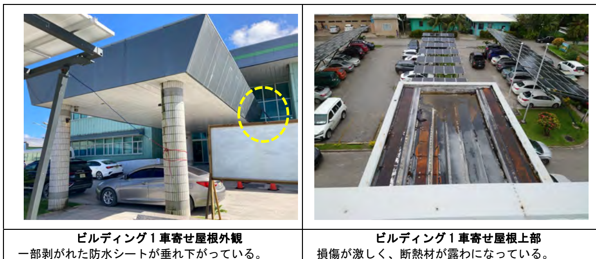
図 2-6 ビルディング1車寄せ 屋根からの雨漏り写真
