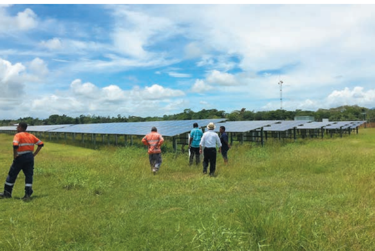
ホニアラ空港の近くに位置するソロモン最大規模の太陽光発電施設
