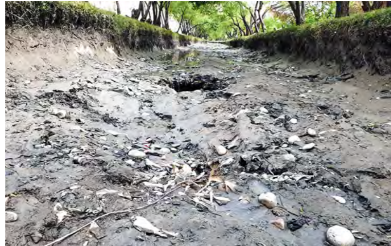
6.36 تصویر: د اوبو لگولو عمومي کانال په بستر کې د اوبو راوتلو واقع کېدنه، د مروارید اوبه لگولو اساسي کانال، FG برخه 1 : April 6, 2020
