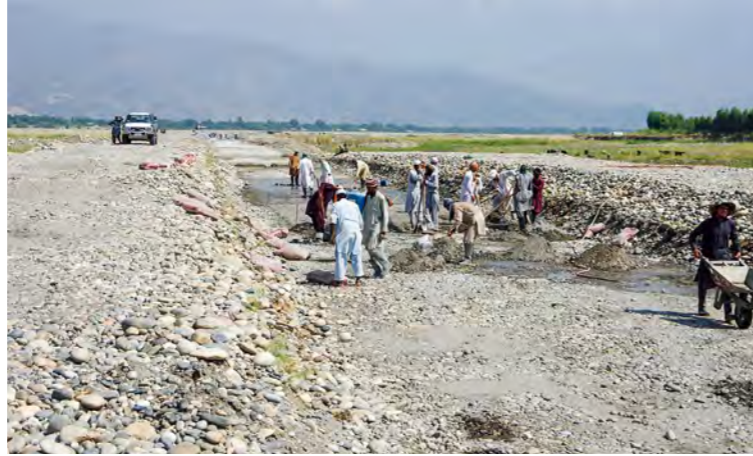
6.30 تصویر: د خاورې او سمټو پوښښ او د کانال د اساس نور کارونه د جوړیدو په حال کې (د میران II اوبو لگولو اساسي کانال)؛ 1 August 27, 2017
