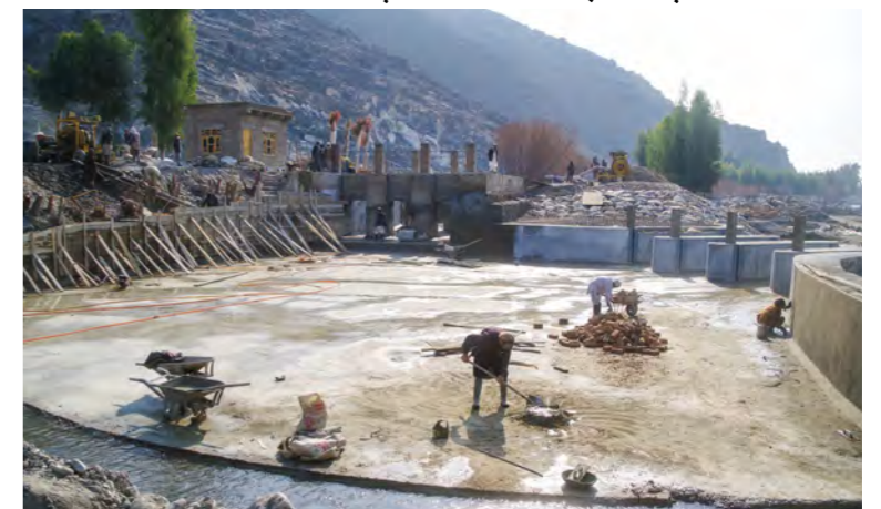
6.19 تصوير : د اوبه نیونکې دروازي او شگی ایستونکې حوض ساختمانی چاری (د کامی لمړی سربند اوبه نیونکې دروازه) 1 : January 22, 2019
