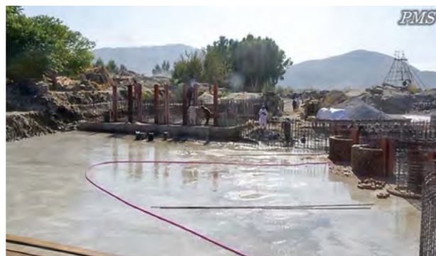
5. د ابگیر سربند، رسوباتو حوض او شگو ایستونکی مجرا جوړولو چاری: د تهداب، اساسی سیول کارونو، د ماشین کارونو، استحکامی کارونو او نورو کارونو ترسره کول. (مروارید II سربند)
