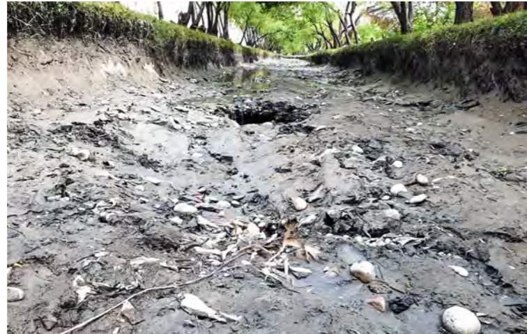
تصویر 6.36: وقوع درز، سوراخ و نشست بروی بستر کانال اصلی آبیاری (کانال اصلی آبیاری مروارید دوم، بخش FG) 1 : April 6, 2020
