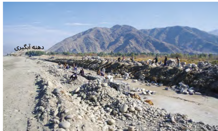
تصویر 6.32: بسته بندی و جایگذاری گابیون‌ها (سطح پایینی) (کانال اصلی آبیاری مروارید دوم) 1 : December 18, 2016
