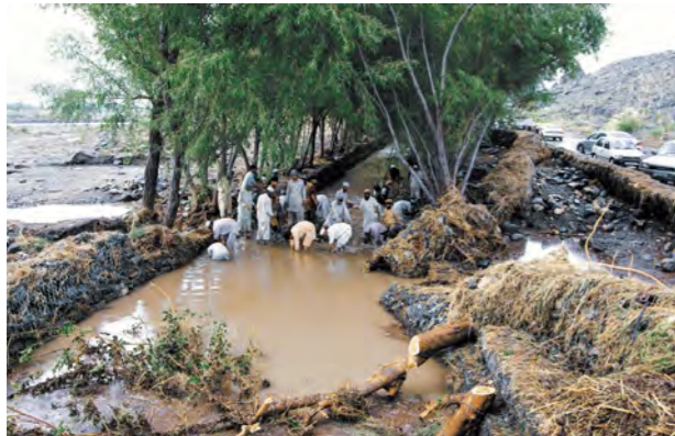
تصویر 7.14: تخریب کانال اصلی آبیاری به علت سیلاب آبی و جریان کل و لای ۱
