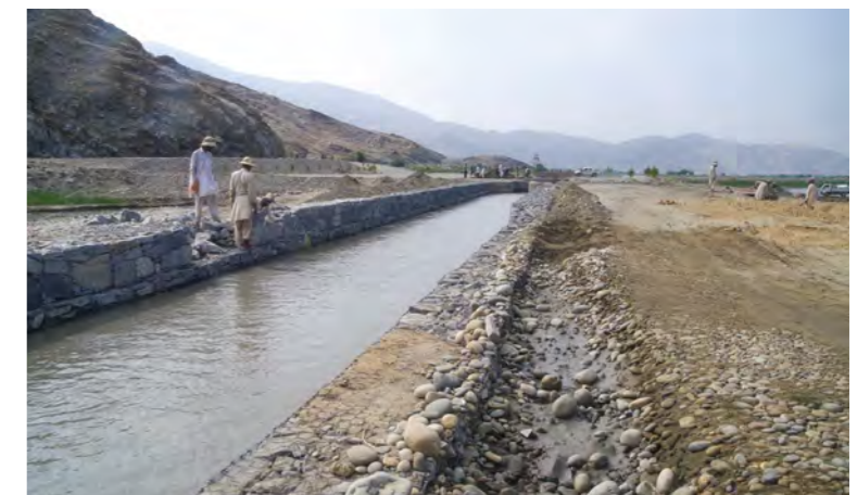
تصویر 6.35: اعمار پشته های کانال توسط گابیون ها (کانال اصلی آبیاری مروارید دوم) 1 : July 18, 2018
