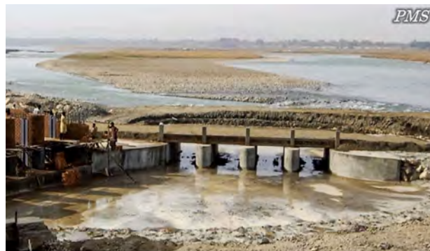
6. تدارک یک پل موقتی بالای مجرای تخلیه ریگ: به منظور عبور ماشین آلات سنگین که در ساخت بدنه اصلی سربند آبگیر دخیل اند (سربند دوم مروارید).
