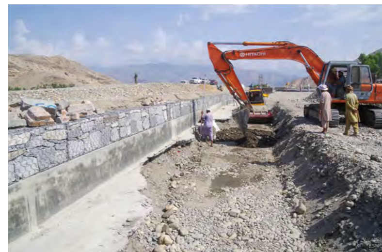
تصویر 4.15: نشست بستر کانال به دلیل شرایط نامناسب اساس ۱
