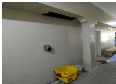
開院してから施設改修はなく、老朽化が進んでいる。天井が崩れ落ち、水漏れがあった。
