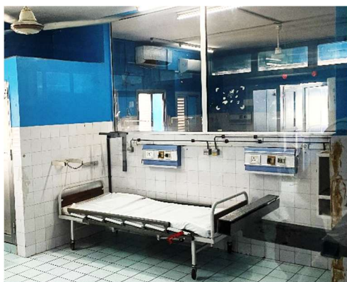
観察室 (小児科) 病床に電源や配管はあるが、患者監視装置や吸引器、ネブライザー等の基本的な機材が整備されていない。
