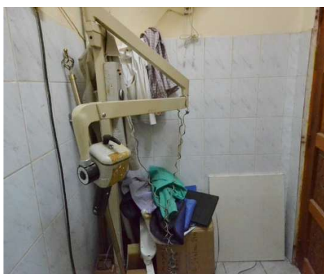
歯科 X 線撮影装置 (歯科) 故障しており、稼働していない。
