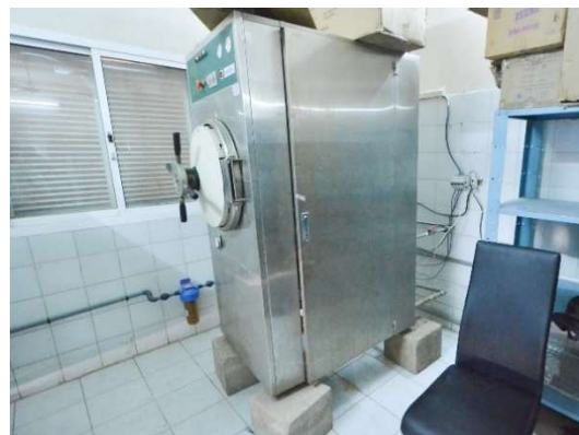
高圧滅菌器（滅菌室） 故障しており修理不能の状態にある。現在は新規購入した滅菌器を使用しているが、容量が不足している。
