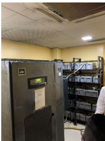
写真5 UPS室。MRI室に隣接して設置されている。
