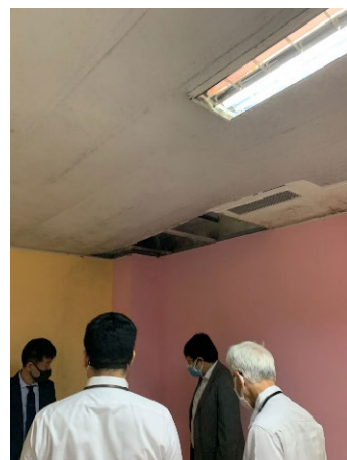
写真6 OPD棟の地階に位置する部屋では、天井内に漏水によるカビの発生を確認した。
