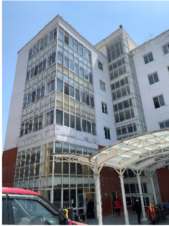
写真1 OPD棟の外観。外壁タイルは一部ひび割れや剥がれが見られた。
