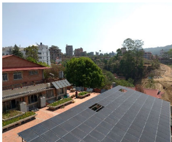
写真 22 病院本棟の屋根に多く設置されている太陽光パネル。
