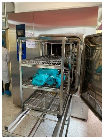
写真 14 病院本棟に設置されたオートクレーブ。
