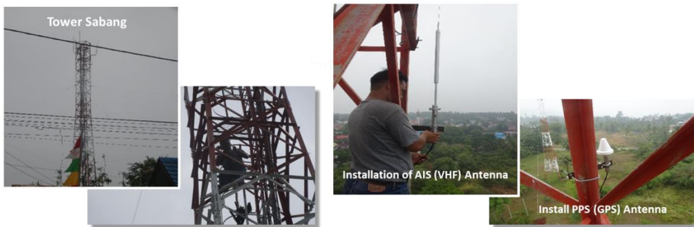
Gambar 5 -2 : Instalasi AIS dan Antena GPS
