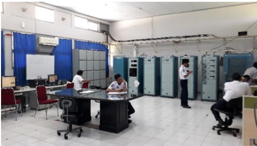
Gambar 4.1.7 -3 : Peralatan dan Ruang Operasional GMDSS
