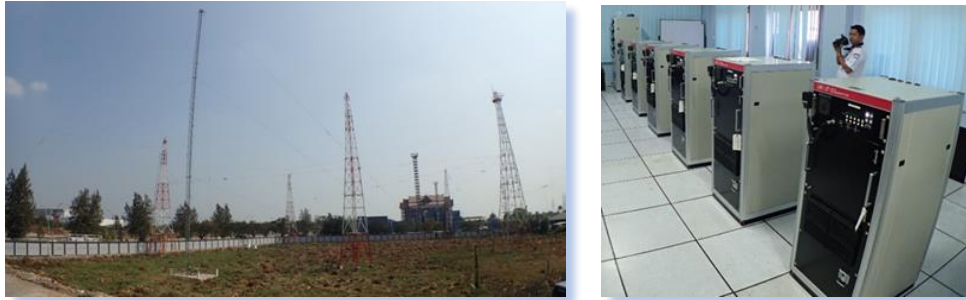
Gambar 4.1.4 -2 : Menara Antena HF, MF, Transmitter dan Unit Kontrol
