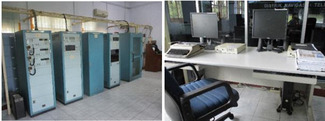
Gambar 4.1.13 -5 : MF/HF, VHF TX/RX, Konsol GMDSS
