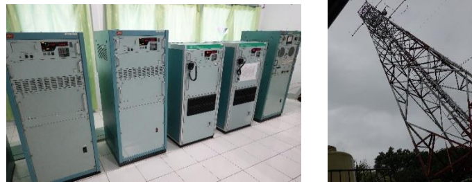
Gambar 4.1.2 -3 : MF/HF dan NAVTEX, Menara Antena VHF
