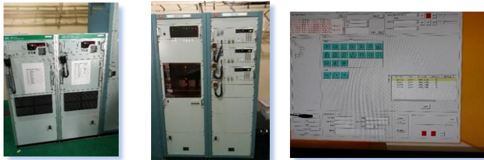
Gambar 4.1.3 -3 : HF TX, VHF TX, Panel Konsol GMDSS
