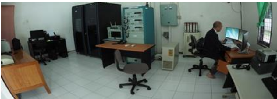
Gambar 4.1.8 -7 : Ruang Operasional SRP
