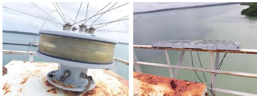
Gambar 4.1.3 -5 : Lampu LED dengan tenaga surya dipasang di dermaga DISNAV
