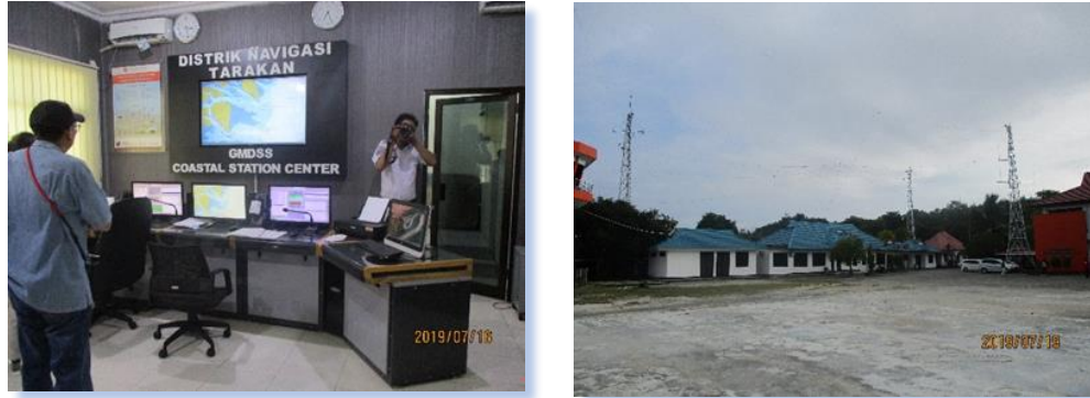
Gambar 4.1.6 -5 : Ruang Operasional GMDS, Fasilitas Menara Antena
